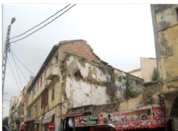
Bâtit totalement effondré
