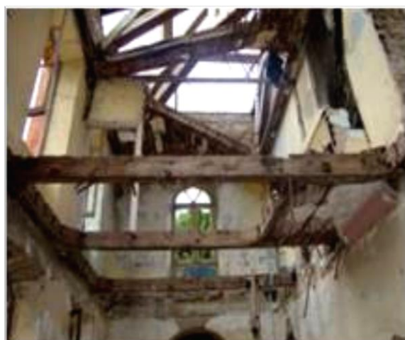
Bâtit partiellement effondré
