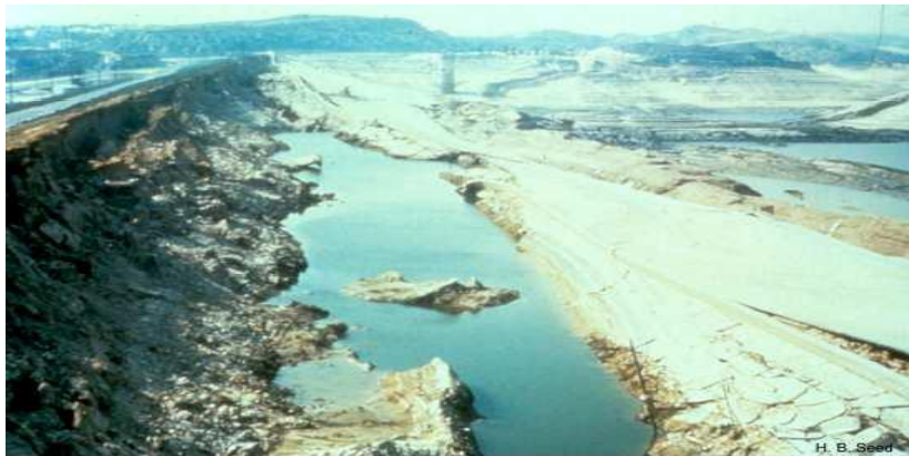
Figure 7- Barrage de Lower Van Norman après le séisme de San Fernando en 1971
