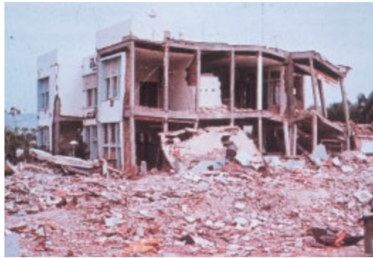
Figure 2.8: Ossature instable Destruction des panneaux en maçonnerie. (Chlef, 1980).
