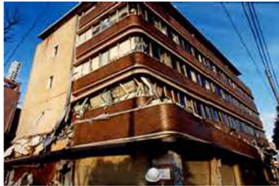
Figure 2.14: Rupture en cisaillement d'un poteau court. (Kobe, 1995).
