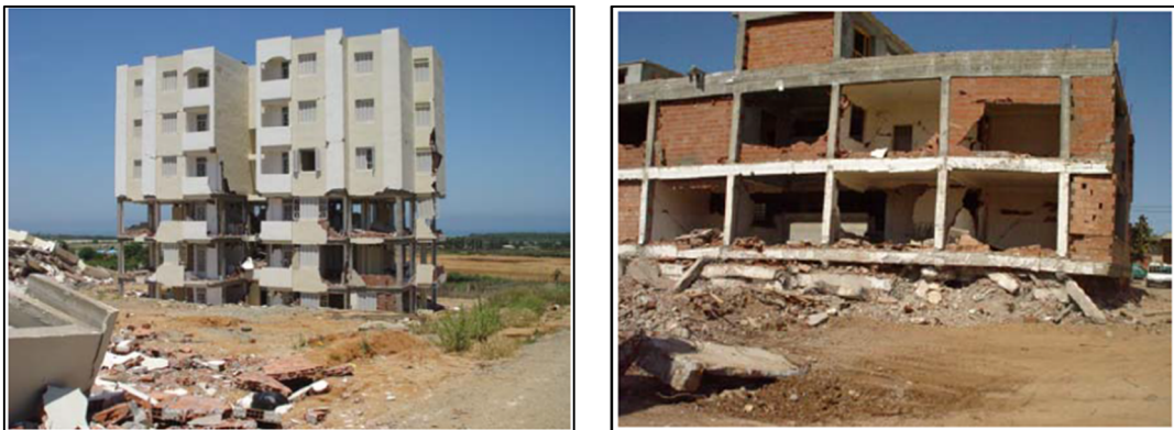
Figure 2.1 : Effondrement partiel et total de constructions en BAMR (Boumerdès 2003).
