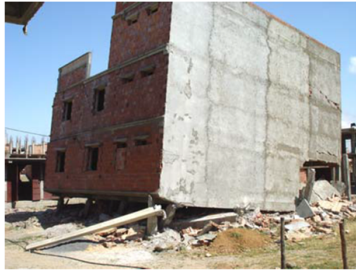
Figure 2.12: Effondrement du RDC d'un bâtiment dû à l'effet de l'étage souple. (Boumerdès, 2003).
