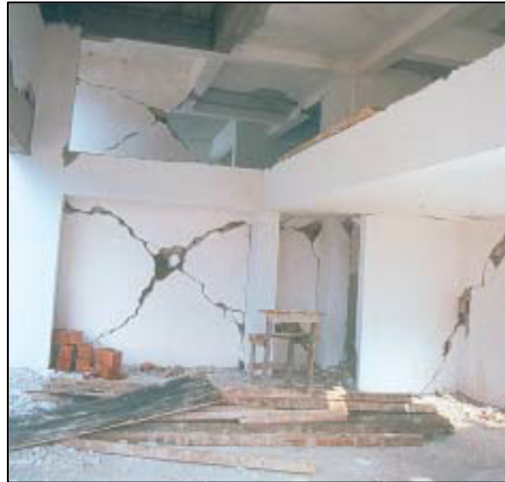
Figure 2.4: Fissures en X sur des murs en maçonnerie remplissant des cadres en béton armé. (Turquie, 1999).
