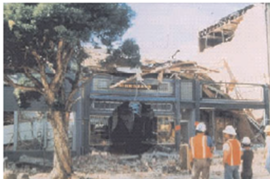
Figure 2. 9: Éclatement d'un panneau de remplissage en maçonnerie et chute sur un immeuble voisin. (Californie, 1989).
