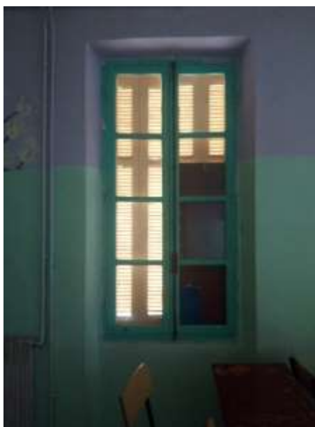
Figure 7.21 : Planches de bois entravant la pénétration de lumière du jour.
