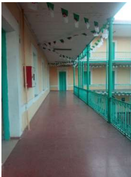
Figure 7.16 : Teinte claire sur la partie basse des murs favorise les salissures (coursive du cas amélioré).
