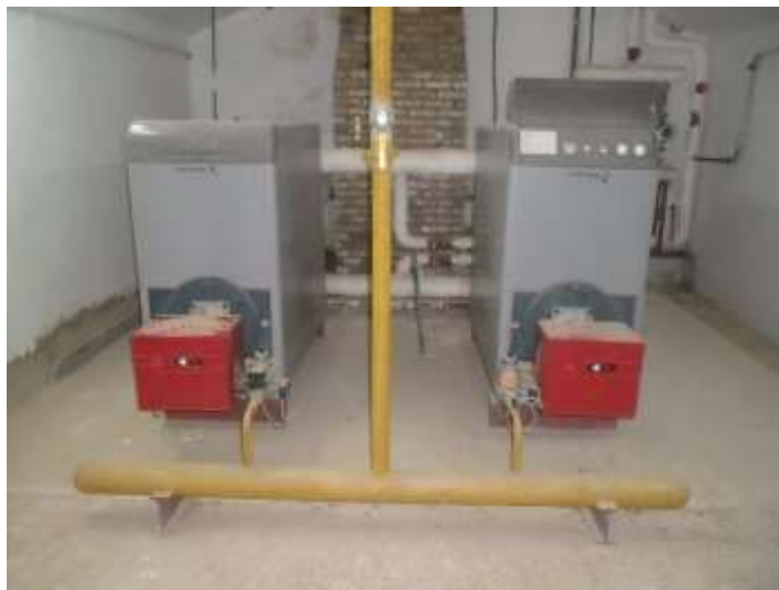
Figure 7.8 : Chaudières installées en 2013 suite aux travaux de réhabilitation.
