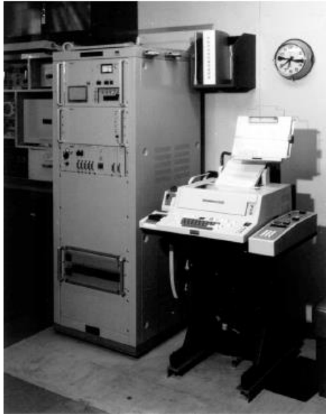
Figure 13 : Photographie de l'équipement sous le pont (BDE) installé dans une cabine de navire
