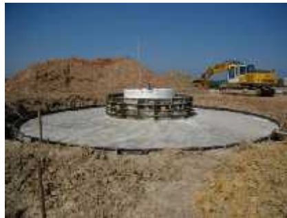
Figure I.8 : Base d'une éolienne
