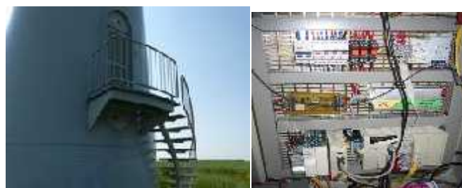
Figure I.9.a : Entrée du local électrique Figure I.9.b : Armoire électrique
