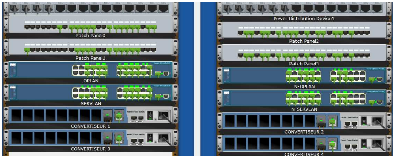
Figure IV.6 : Les racks de l'ancienne/nouvelle tour.
