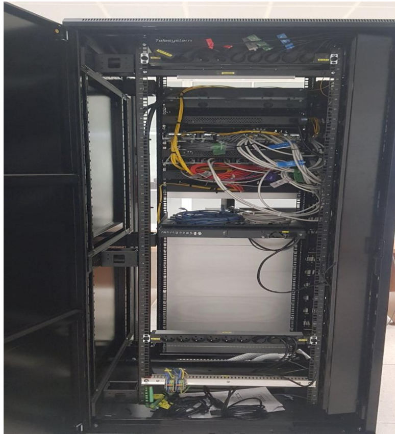
Figure IV.5 : Photo de face de l'installation des trois switches OPLAN A, OPLAN B SERVICE LAN.
