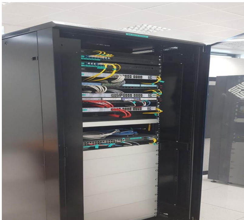
Figure IV.4 : Photo de face de l'installation des trois switches OPLAN A, OPLAN B SERVICE LAN.
