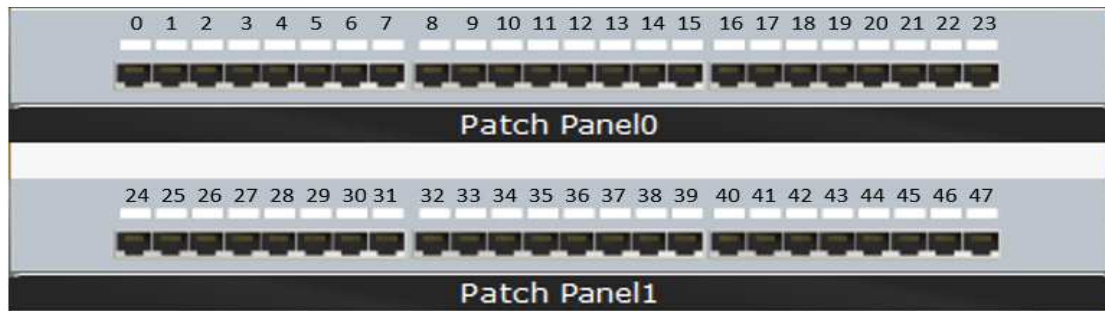
Figure II.5 : La numérotation des ports du patch panel.
