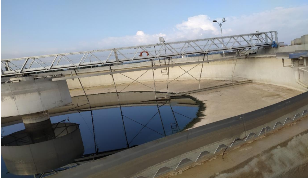
Figure 3.8. Décanteur primaire vide montrant la lame inoxydable, la trémie, et les racles de surface.
