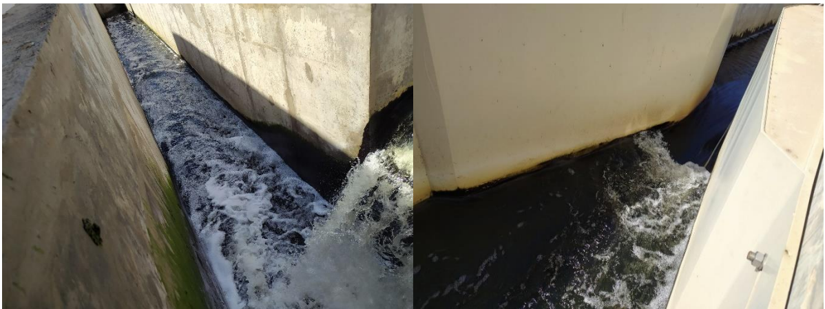
Figure 3.15. Canal de venturi de la sortie de la station de Boufarik
