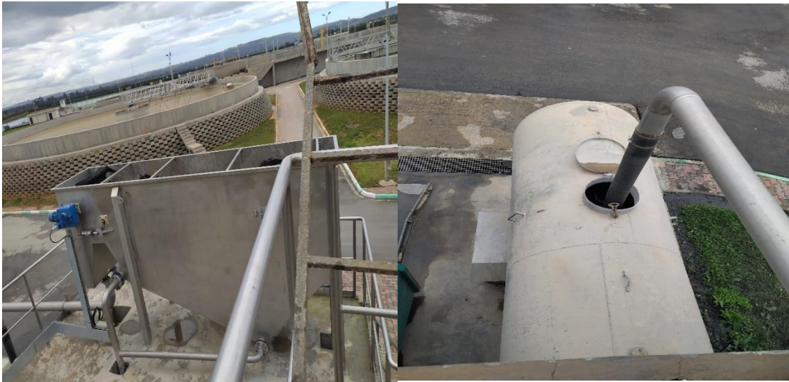
Figure 3.7. La fosse et la citerne de stockage des huiles déversées
