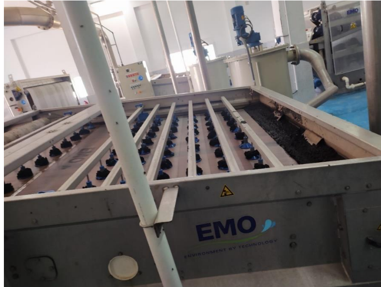
Figure 3.19. La Table d'égouttage
