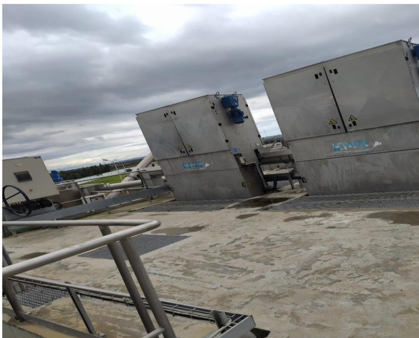
Figure 2.3 : Dégrilleur fin du step de Boufarik
