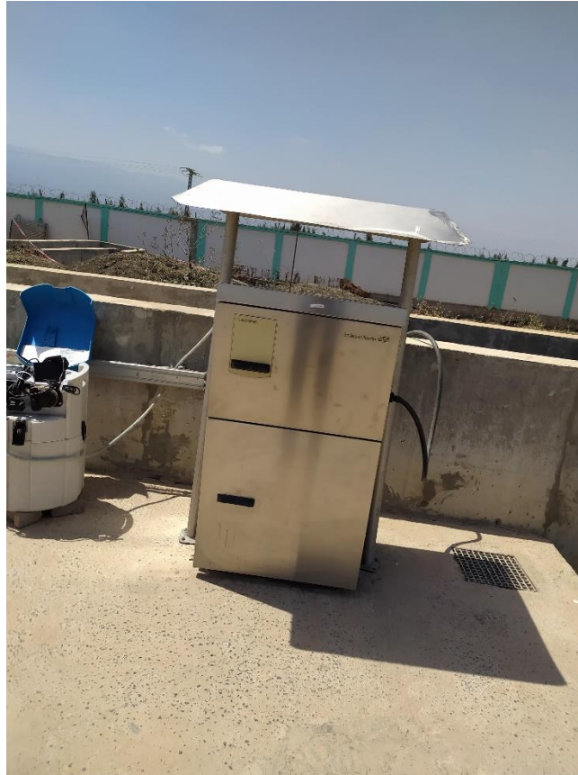
Figure 4.2. Releveur automatique de la sortie de la step de Boufarik
