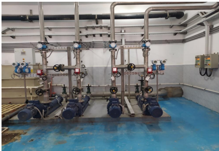
Figure 3.20. Les pompes dédiées pour l'injection du polymère
