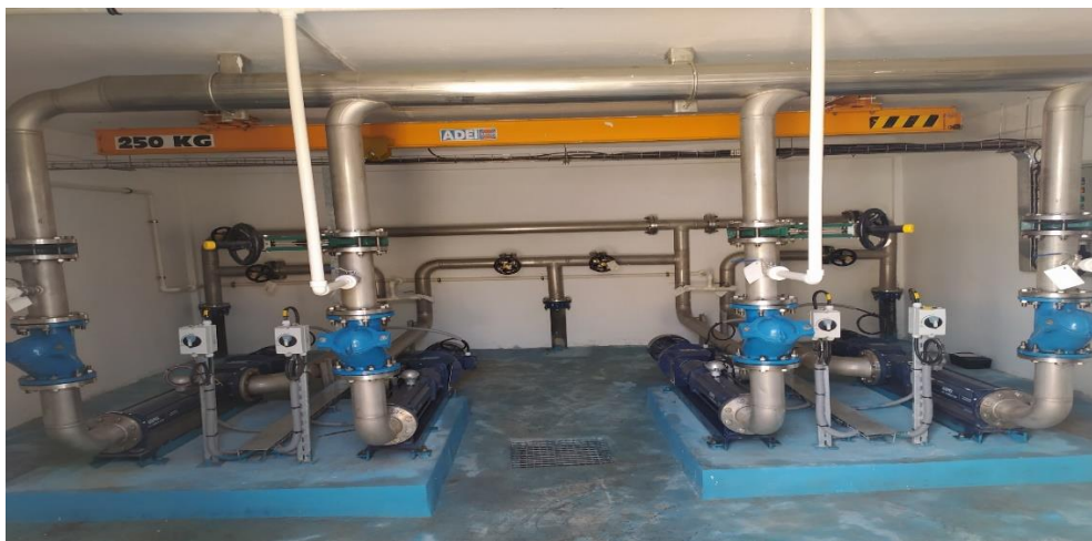
Figure 3.16. Les pompes centrifuges des boues en excès
