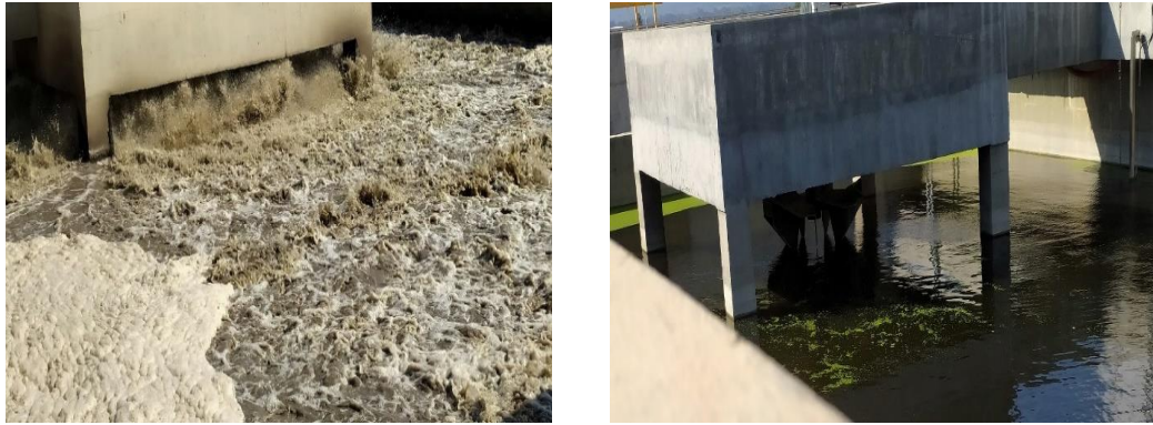
Figure 3.9. Turbine de surface du bassin d'aération en état stable et en marche
