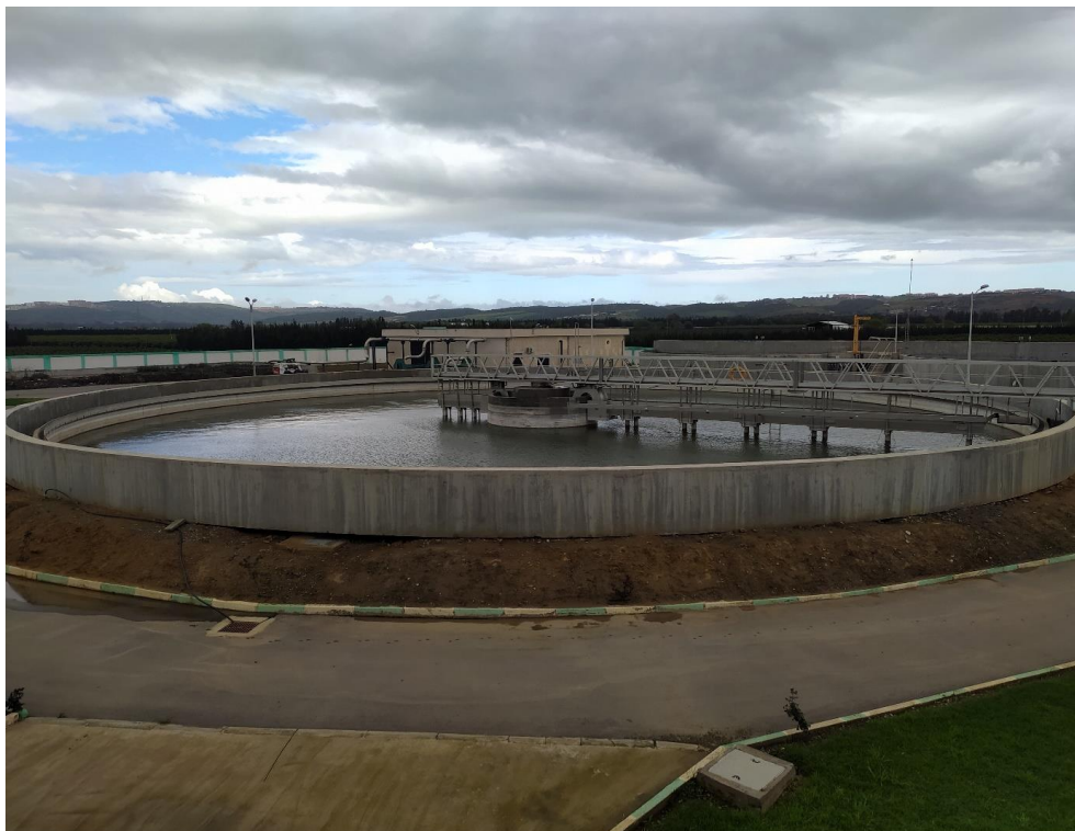
Figure 3.14. Clarificateur de la Step de Boufarik
