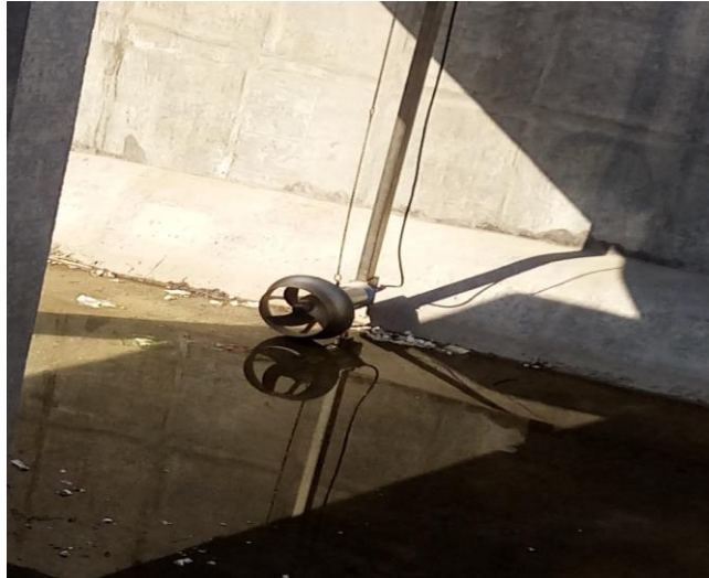
Figure 3.12. Aérateur de surface du bassin biologique
