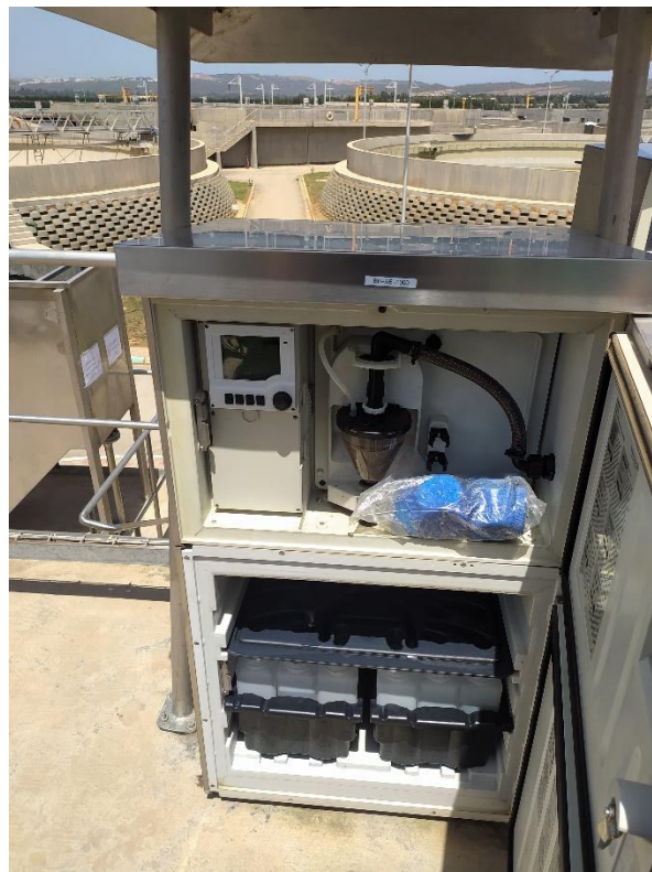
Figure 4.1. Releveur automatique du prétraitement de la step de Boufarik
