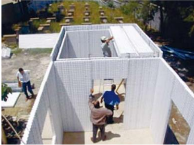
Figure 1- 10: Réalisation de bureaux - Coffrages isolants. En polystyrène, Souidania, Siège du CNERIB, Algérie (Source : EL HASSAR, 2002)
