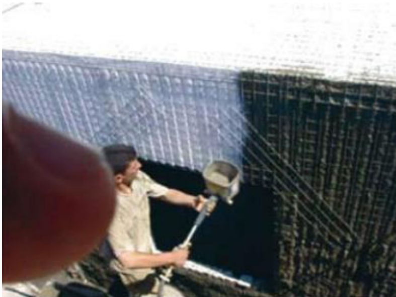
Figure 1- 11: Réalisation de bureaux - Coffrages isolants. En polystyrène, Souidania, Siège du CNERIB, Algérie (Source : EL HASSAR, 2002)
