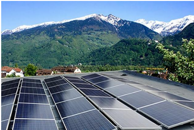
Figure A.II 1Panneaux photovoltaïques Orientés Est-Ouest
