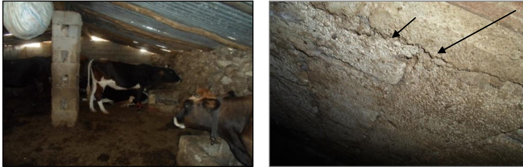
Figure.3.15 &3.16: Présence de crevasses aux murs des étables .
