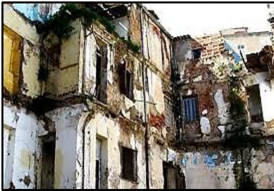
Fig. 01 : Détérioration du vieux bâti, Alger
