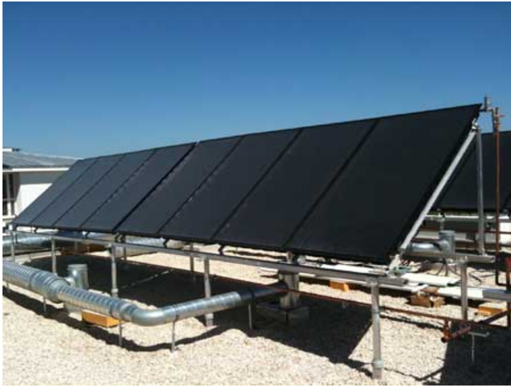
FIGURE 1.4 – exemple capteur solaire fixe [3]
