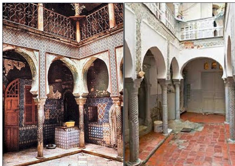
Figure II.8 : L'état de dégradation du bâti résidentiel ottoman d'Alger.
