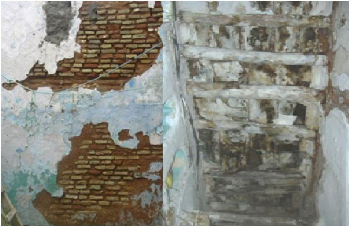
Figure II.15 : L'utilisation de nouveaux matériaux et le manque d'entretien des matériaux originaux
