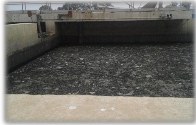
Photo N°11 : Bâche de stockage des boues
