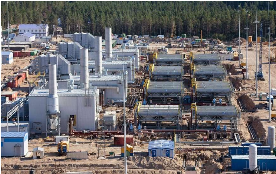
Figure 5-3: Une station de compression avec (turbocompresseurs)
