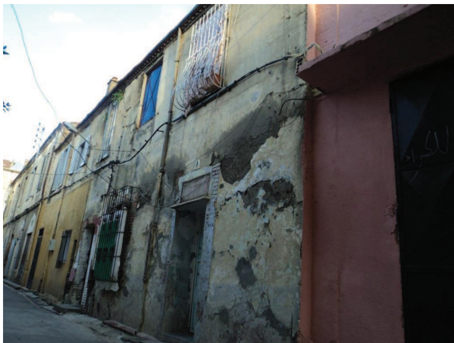
Figure.3.13 Construction en mauvaise état
