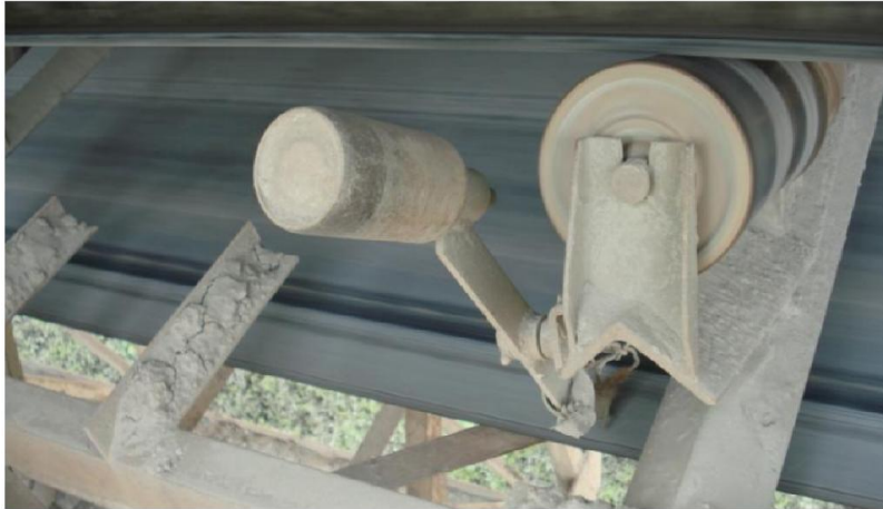
(Figure 2.17) : Contrôleur de débordement de bande.
