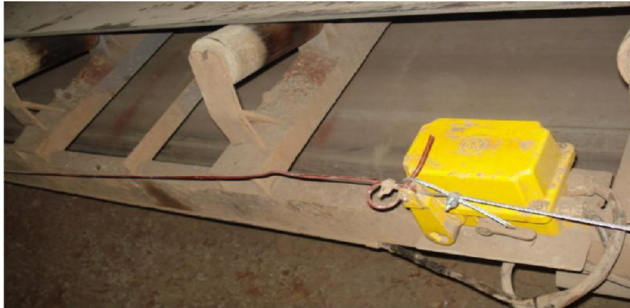
(Figure 2.15) : Câble de sécurité.
