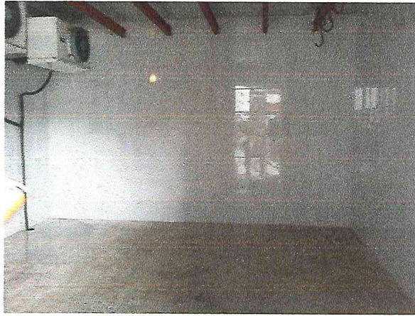
Photos n°08 : chambre froide (Azazga)
