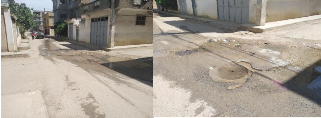
Figure 14:Fuite sur une conduite DN125-AC (Lotissement Mahi)
