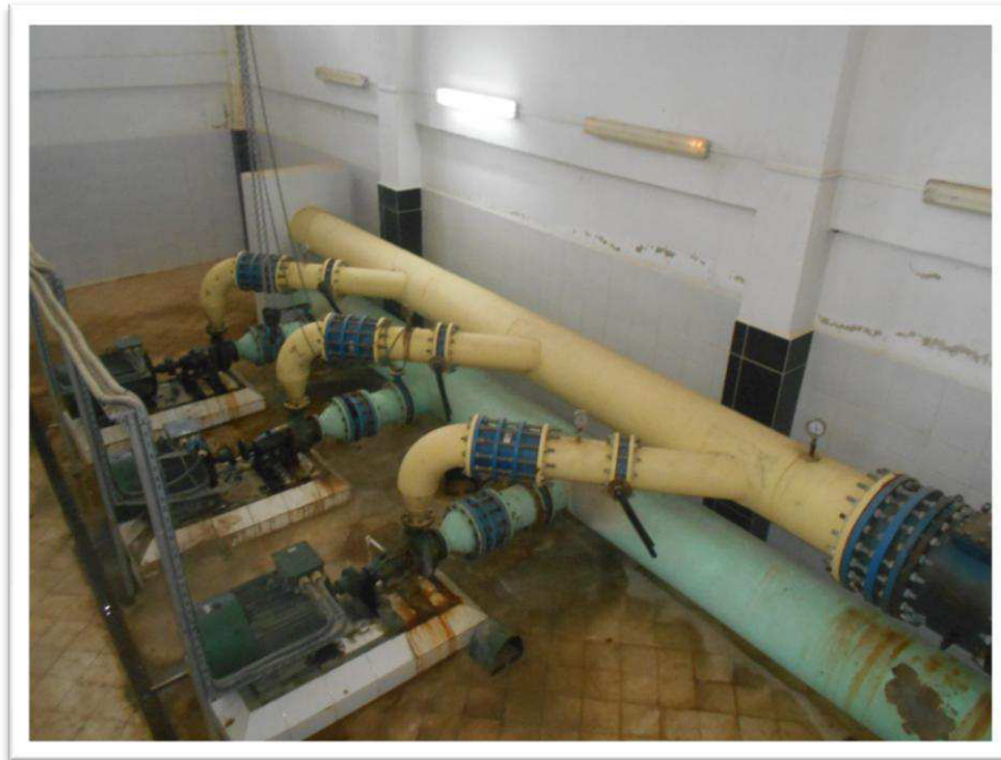
Figure 3 : Équipements de la station de pompage de Chebli
