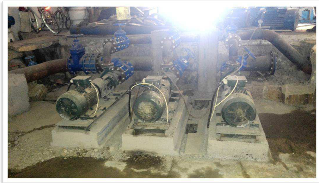
Figure 28 : L'équipements de la station de pompage du centre ADE
