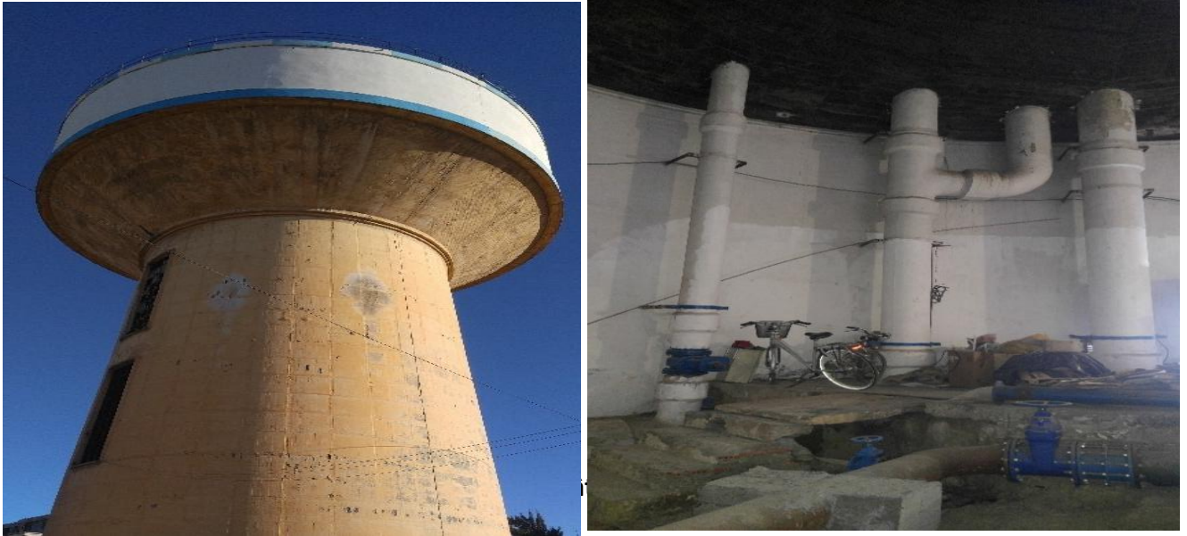
Figure 15: L'extérieur et intérieur du château d'eau 1500 m 3 (Centre ADE)
