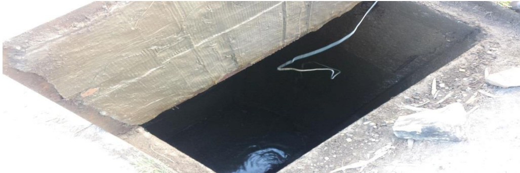
Figure 5. Photo de l'égout principal de l'hôpital de Frantz Fanon.
