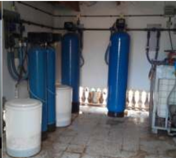
Figure 10 : Station de traitement d'eau pour hémodialyse de la clinique IFRADJ
