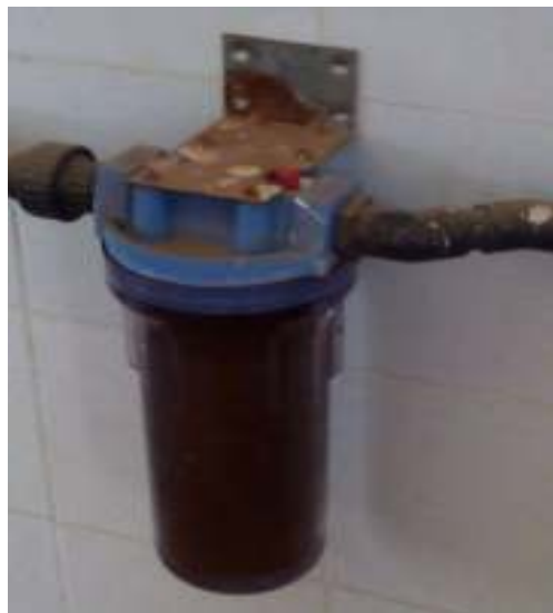
Figure 5 : Filtre à charbon
