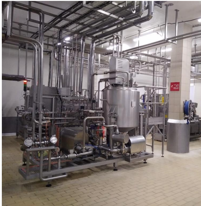
Figure I. 14: le skid de crémage Chef 2.
