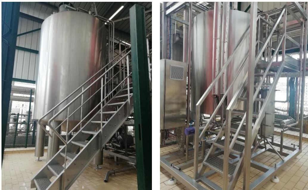
Figure I. 18 : les cuves eaux blanches
