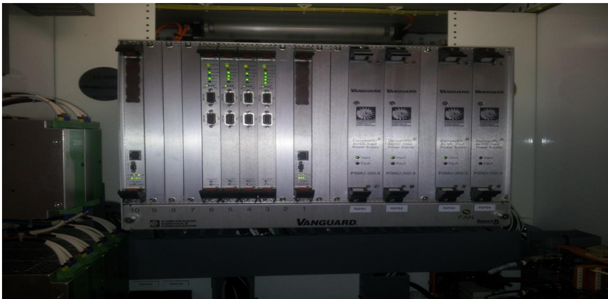
Figure 3.16 : Rack CCC compresseur end flash
