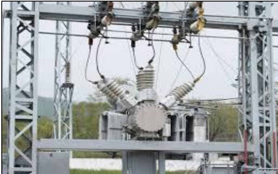
Figure1.15 Transformateurs de puissance
