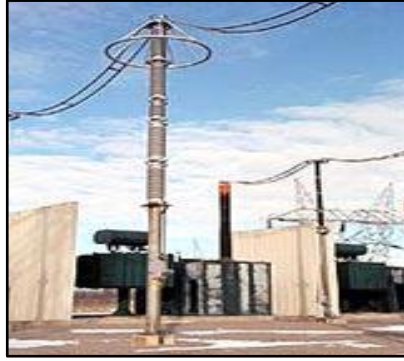
Figure1.20 Parafoudre mise à terre
