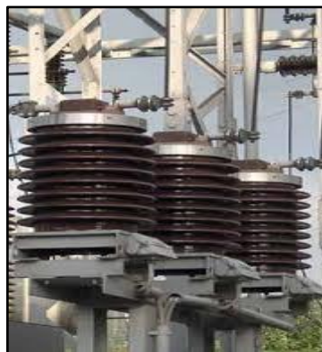
Figure1.18 Transformateurs de courant
