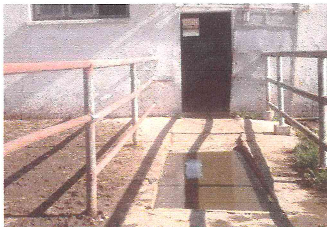
Figure personnelle n°12 : Pédiluve en mauvais état.
