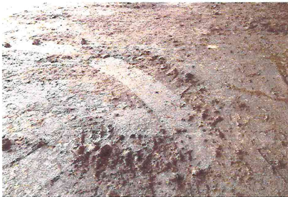
Figure personnelle n° 05 : sol glissant
