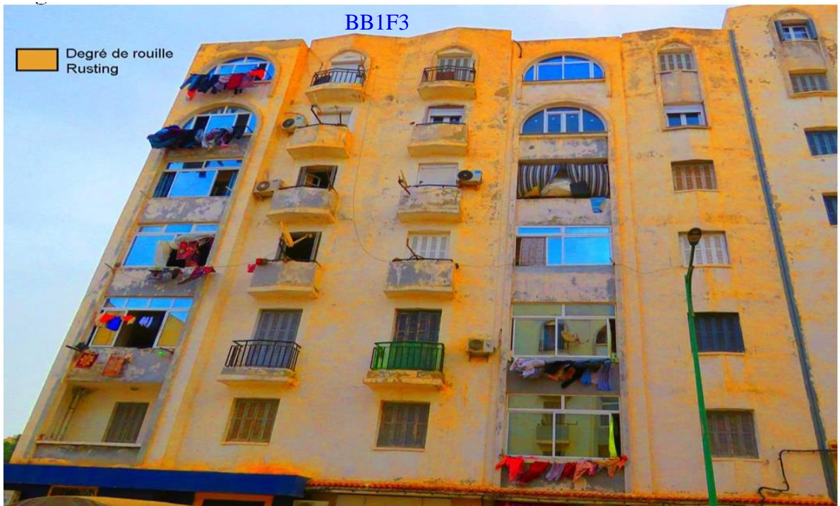
Photo IV.14. Cartographie des altérations des revêtements de peintures – changement de couleur
