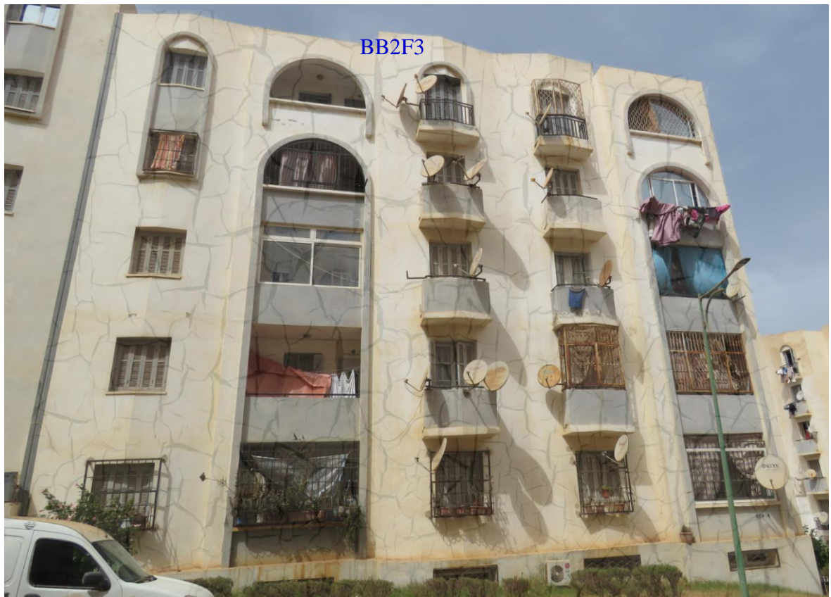
Photo IV.27. Cartographie des altérations des revêtements de peintures – craquellement
