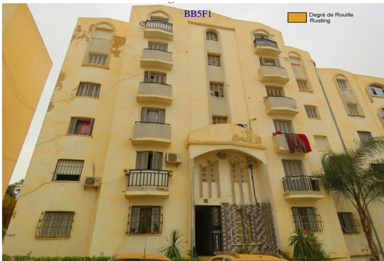
Photo IV.59. Cartographie des altérations des revêtements de peintures –changement de couleur
