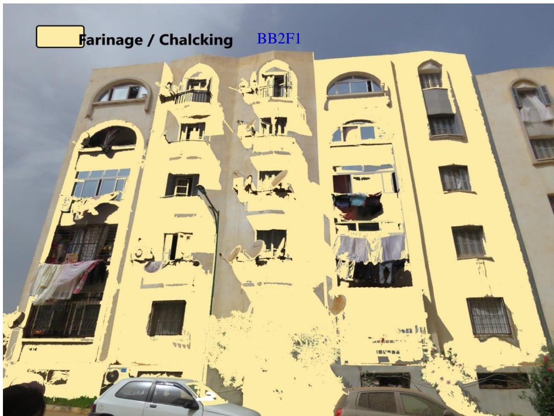
Photo IV.20. Cartographie des altérations des revêtements de peintures –farinage
