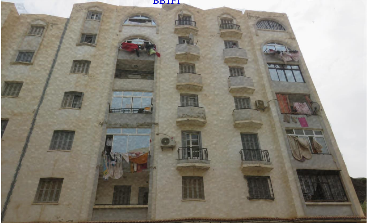
Photo IV.16. Cartographie des altérations des revêtements de peintures –cloquage
