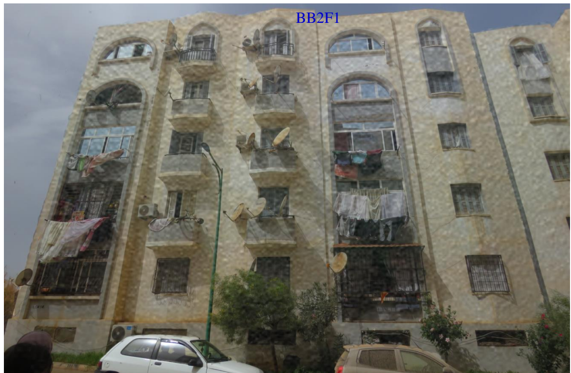
Photo IV.17. Cartographie des altérations des revêtements de peintures –cloquage
