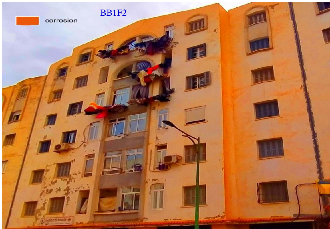
Photo IV.20. Cartographie des altérations des revêtements de peintures –changement de couleur
