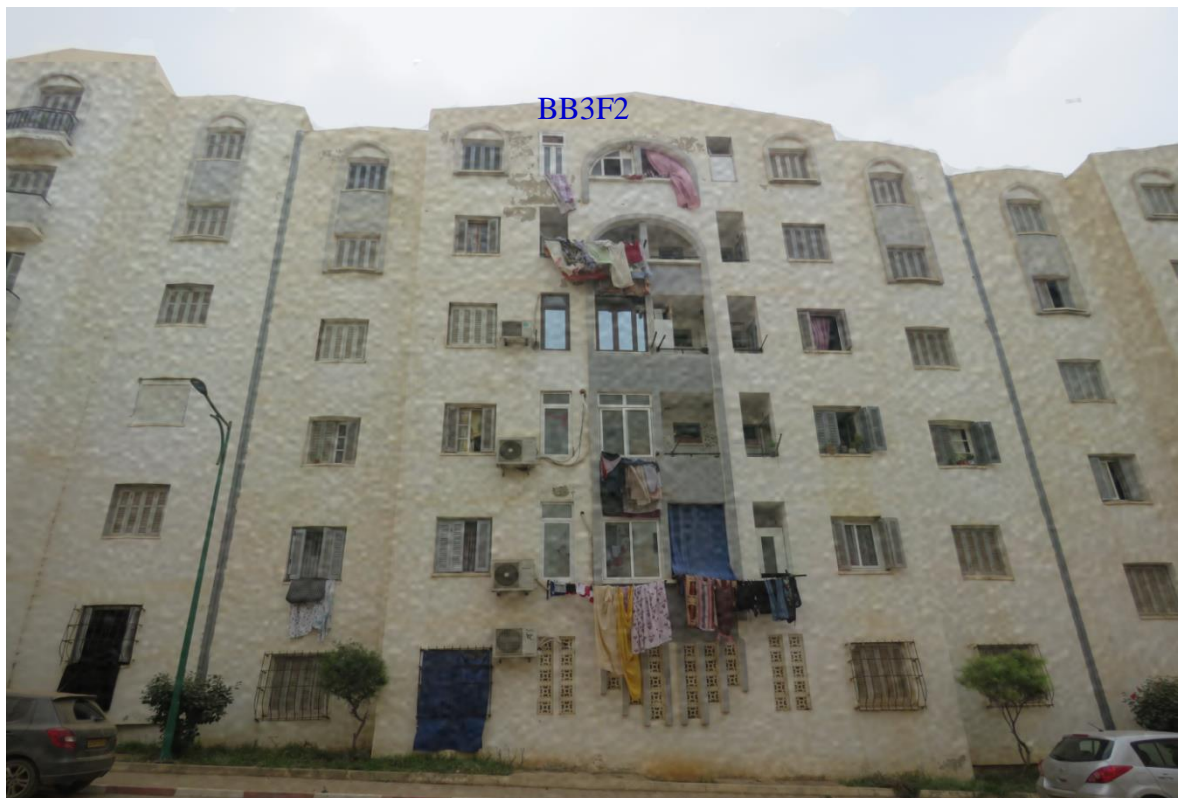
Photo IV.35. Cartographie des altérations des revêtements de peintures –cloquage
