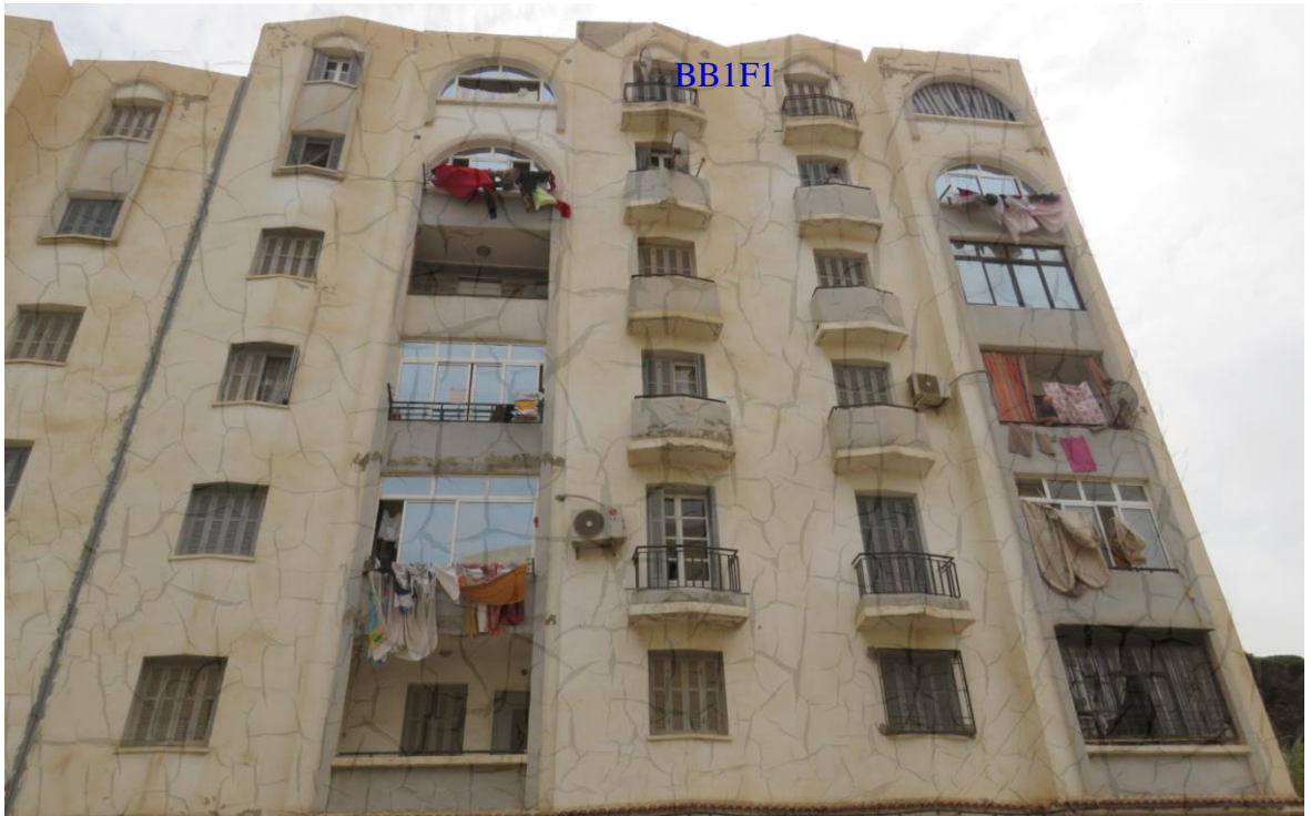
Photo IV.10. Cartographie des altérations des revêtements de peintures –craquellement
