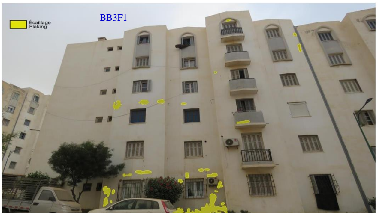
Photo IV.39. Cartographie des altérations des revêtements de peintures –écaillage
