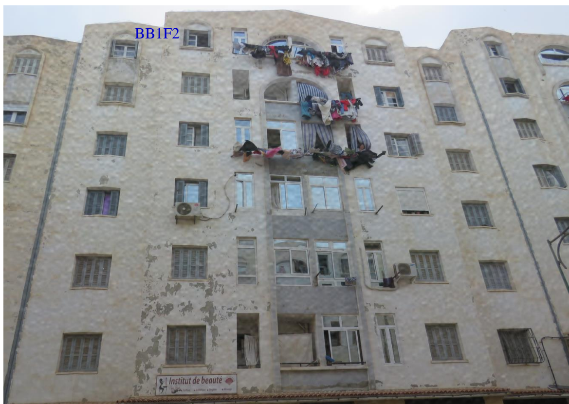
Photo IV.11. Cartographie des altérations des revêtements de peintures –cloquage
