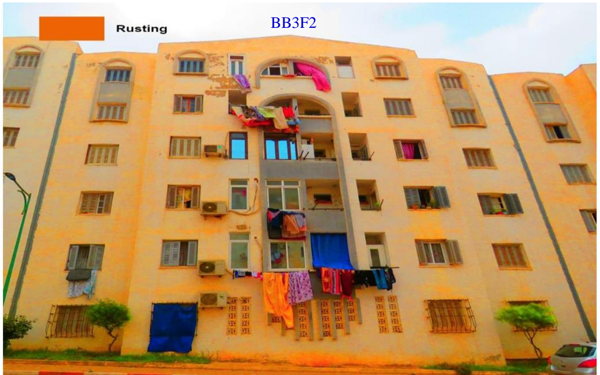
Photo IV.34. Cartographie des altérations des revêtements de peintures –changement de couleur
