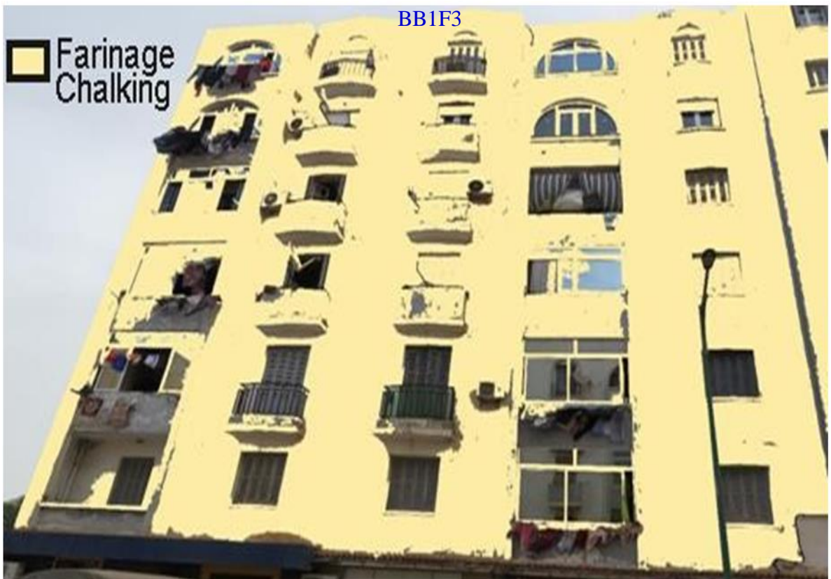
Photo IV.15. Cartographie des altérations des revêtements de peintures –farinage
