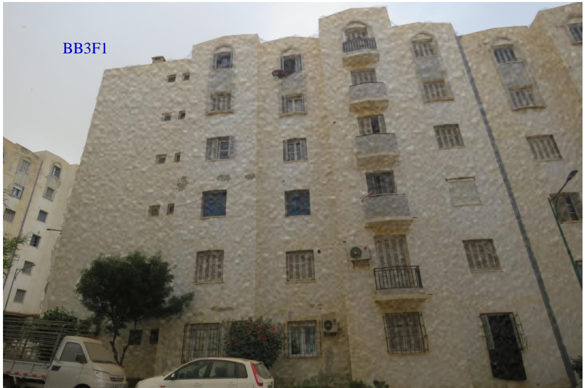
Photo IV.30. Cartographie des altérations des revêtements de peintures – cloquage
