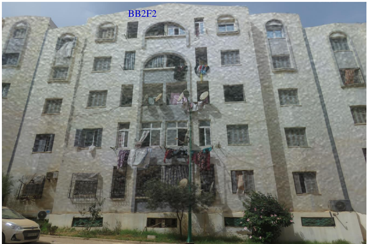
Photo IV.24. Cartographie des altérations des revêtements de peintures – cloquage
