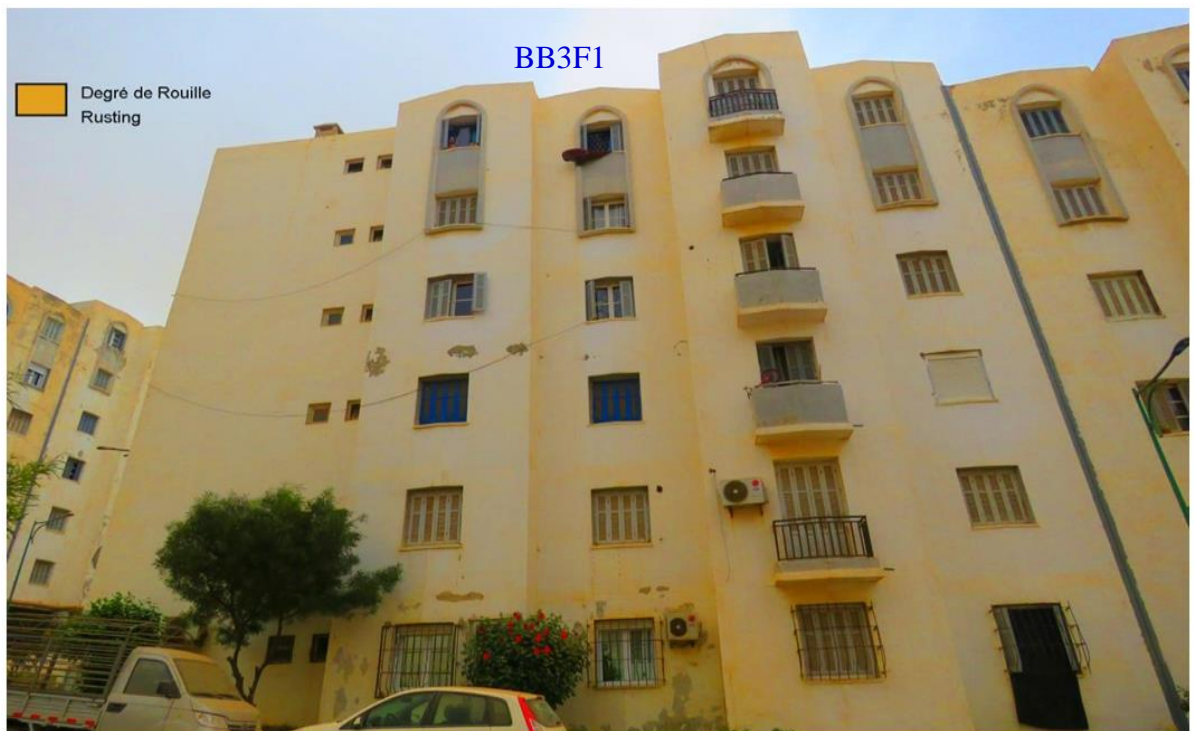
Photo IV.29. Cartographie des altérations des revêtements de peintures – changement de couleur
