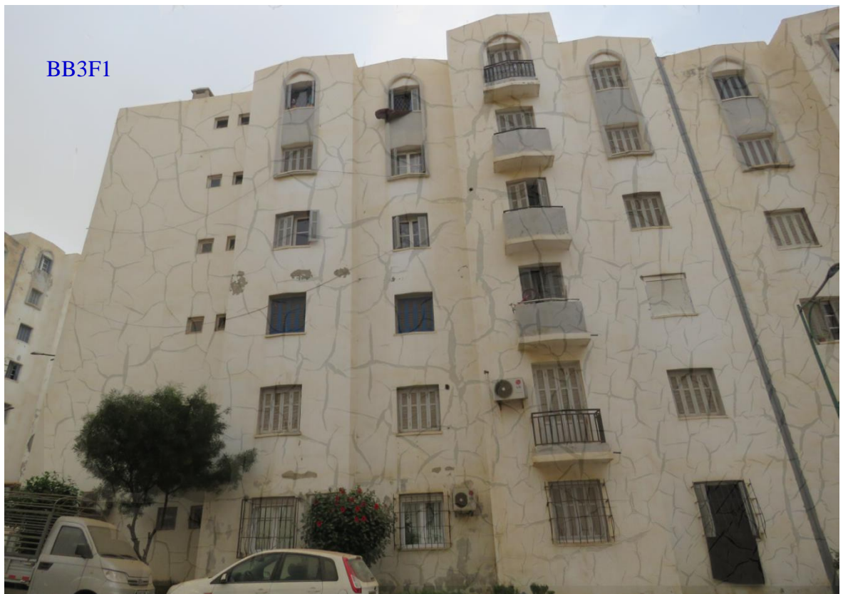
Photo IV.31. Cartographie des altérations des revêtements de peintures – craquellement
