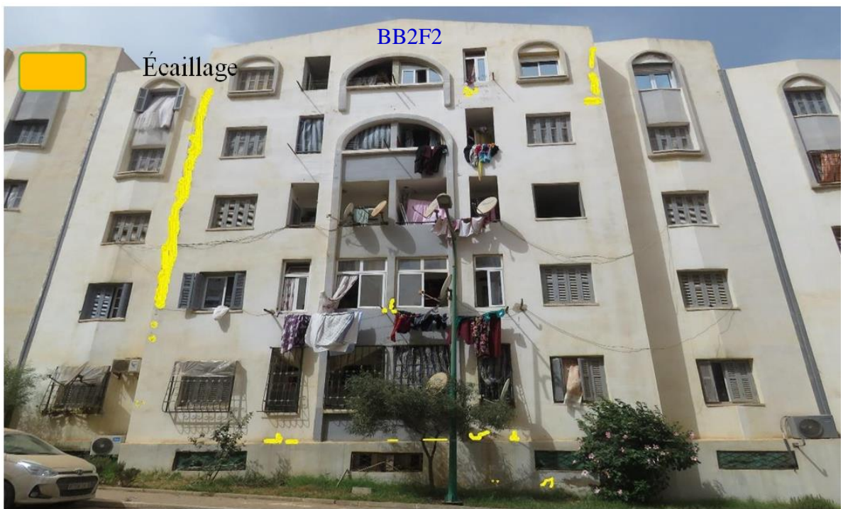
Photo IV.22. Cartographie des altérations des revêtements de peintures –écaillage
