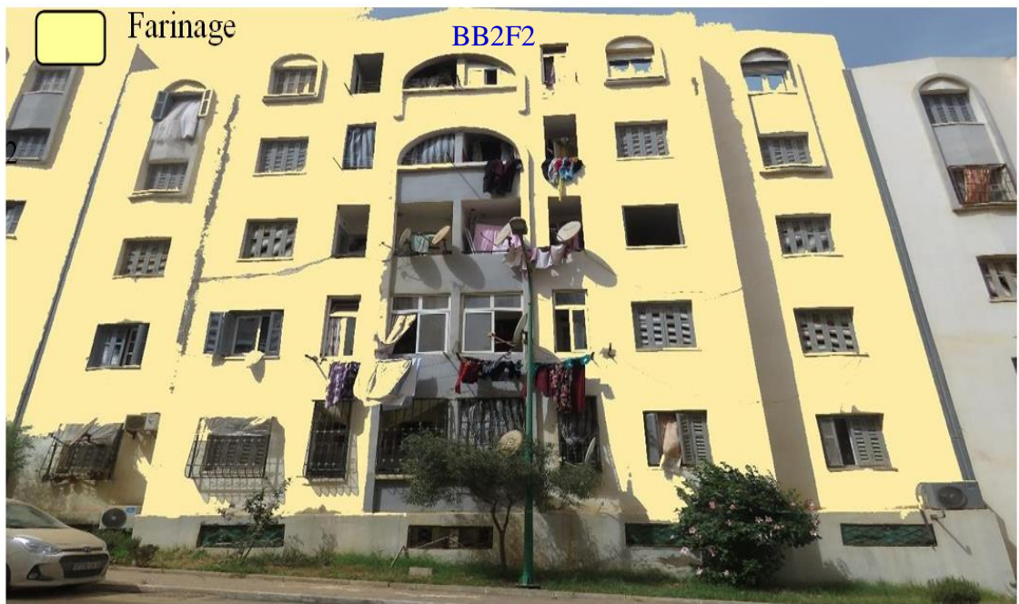
Photo IV.21. Cartographie des altérations des revêtements de peintures – Farinage
