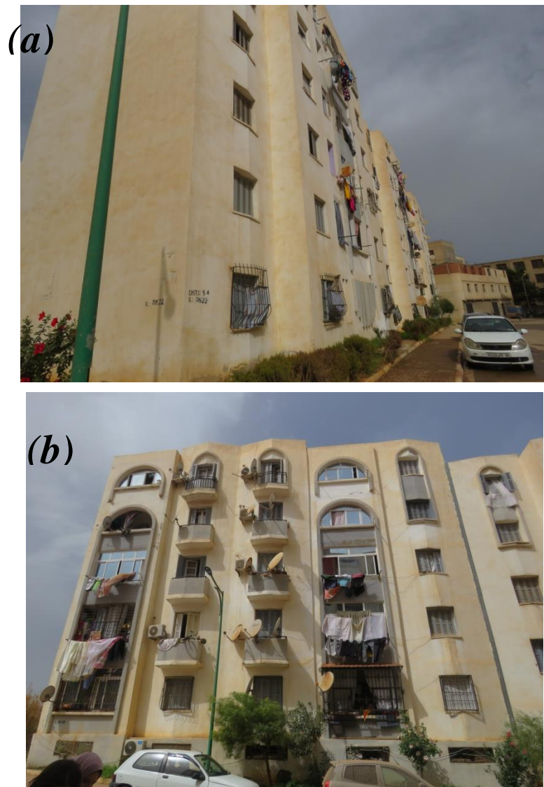
Photo IV.6. Jaunissement aperçu sur les façades des bâtiments (couleur blanche transformée en couleur de rouille donnant un aspect corrodé)(par l'équipe de CNERIB et rabah ben abbes & zekraoui)
