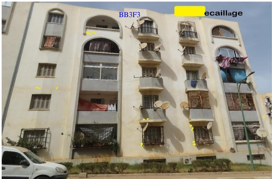
Photo IV.36. Cartographie des altérations des revêtements de peintures –écaillage
