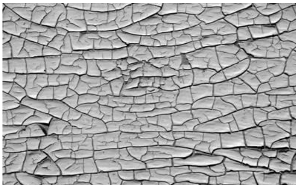
Photo II.5. Transformation de la couche de peinture en peau de crocodile (par BCA.2005)
