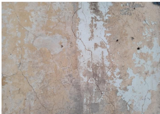
Photo II.20. Un cas de retrait-fissuration de la couche de peinture (par rabah ben abbes et zekraoui)
