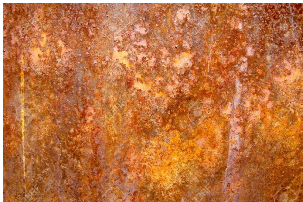
Photo II.12. Corrosion et changement de couleur des peintures de façades extérieures
