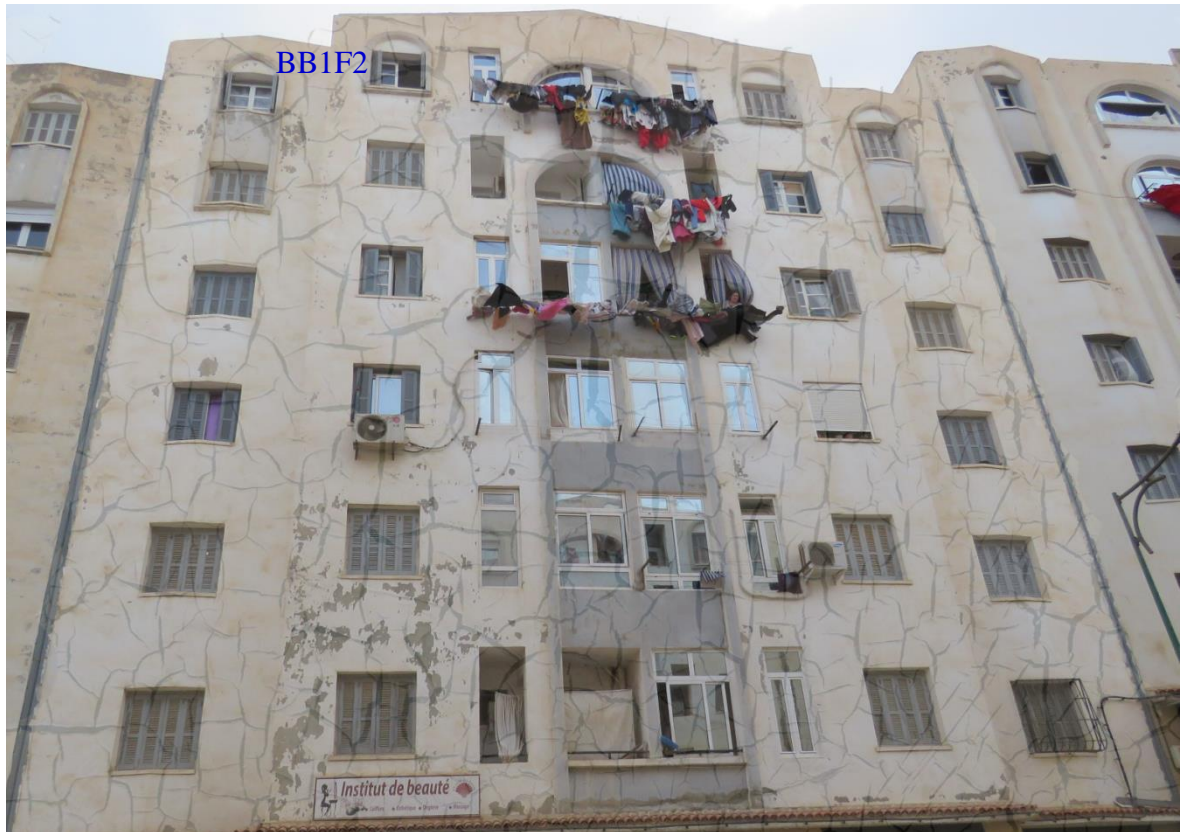
Photo IV.12. Cartographie des altérations des revêtements de peintures –craquellement
