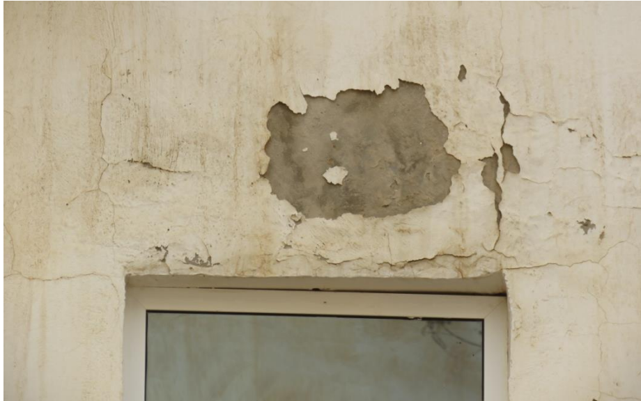
Photo IV.8. Décollement et Écaillage de la couche de peinture résultant de l'exposition aux embruns marin et à l'humidité (par l'équipe de CNERIB et rabah ben abbes & zekraoui)
