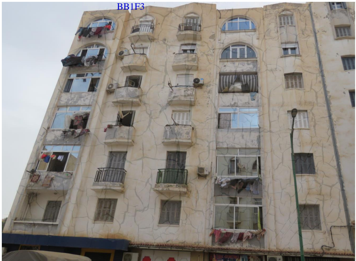
Photo IV.16. Cartographie des altérations des revêtements de peintures –craquellement
