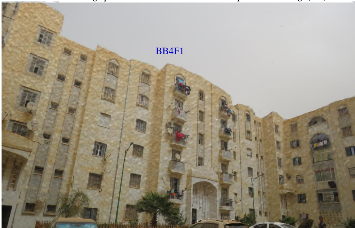
Photo III.43. Cartographie des altérations des revêtements de peintures –cloquage
