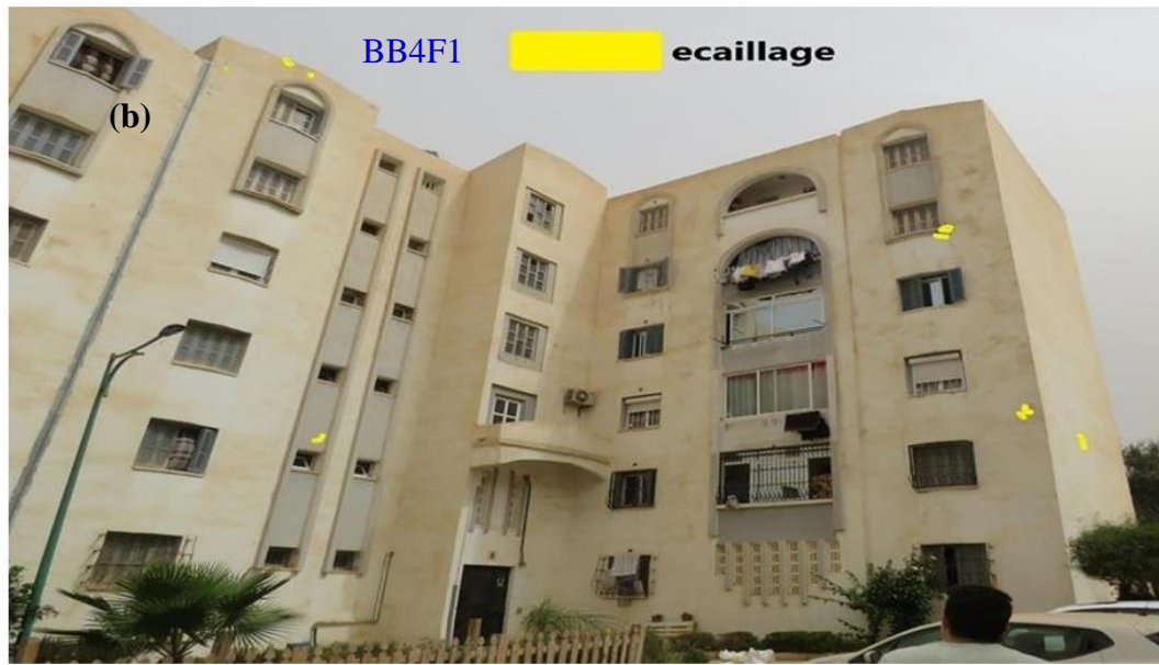
Photo IV.42. Cartographie des altérations des revêtements de peintures –écaillage (a- b)
