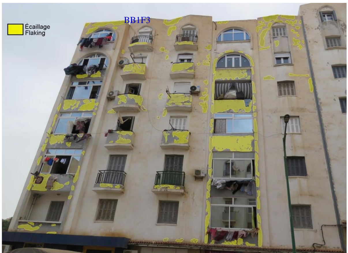
Photo IV.13. Cartographie des altérations des revêtements de peintures –écaillage
