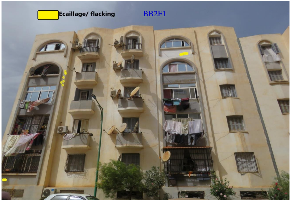
Photo IV.19. Cartographie des altérations des revêtements de peintures –écaillage
