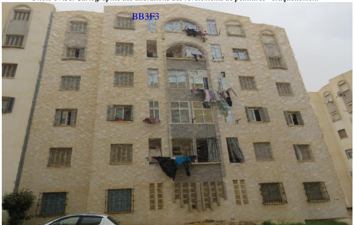
Photo IV.39. Cartographie des altérations des revêtements de peintures –cloquage
