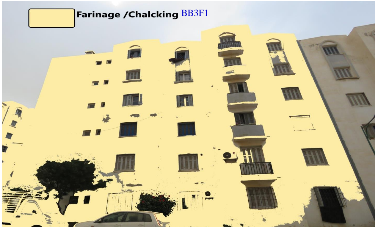
Photo IV.28. Cartographie des altérations des revêtements de peintures – farinage
