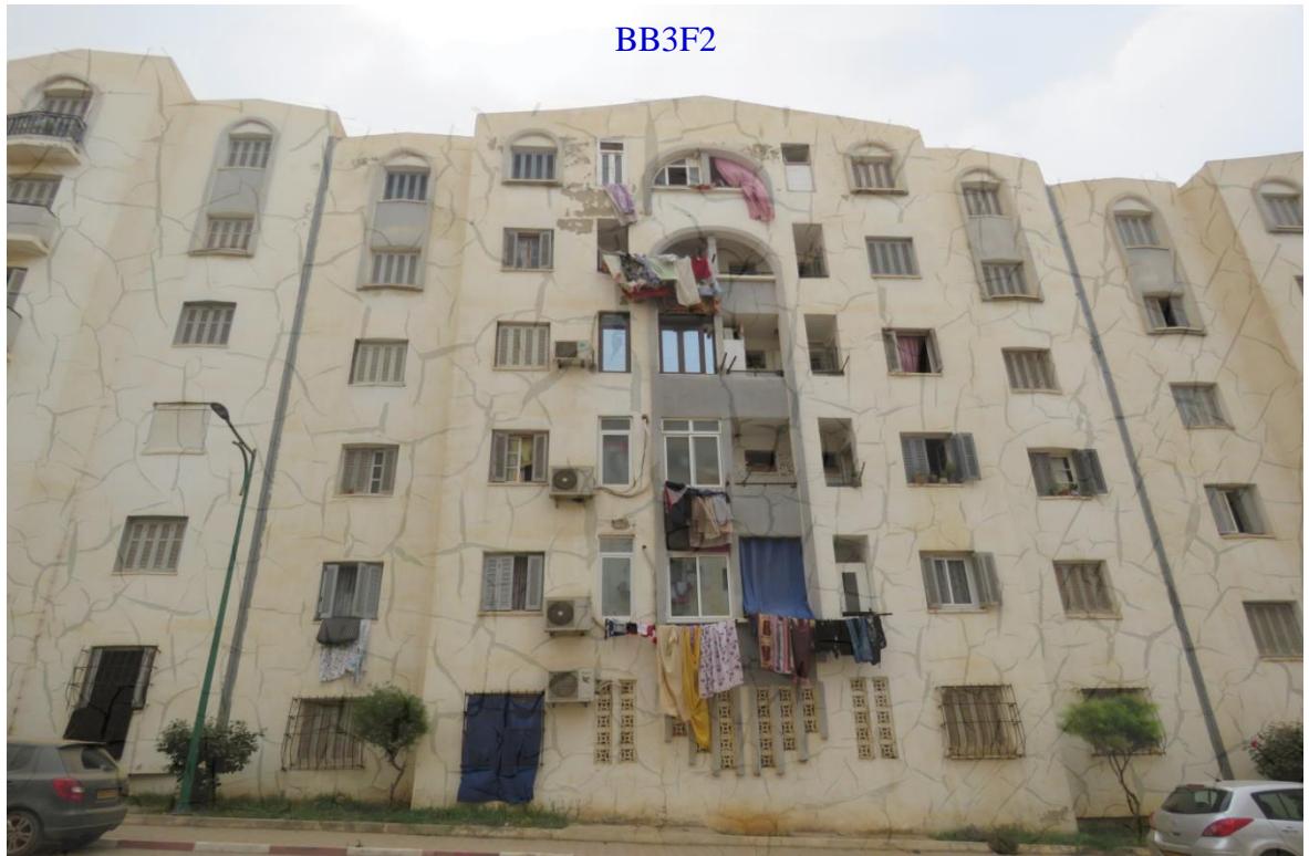
Photo IV.48. Cartographie des altérations des revêtements de peintures –craquellement
