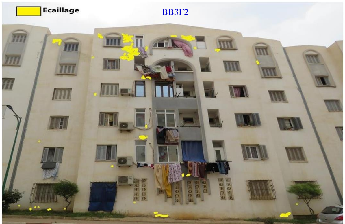
Photo IV.33. Cartographie des altérations des revêtements de peintures –écaillage
