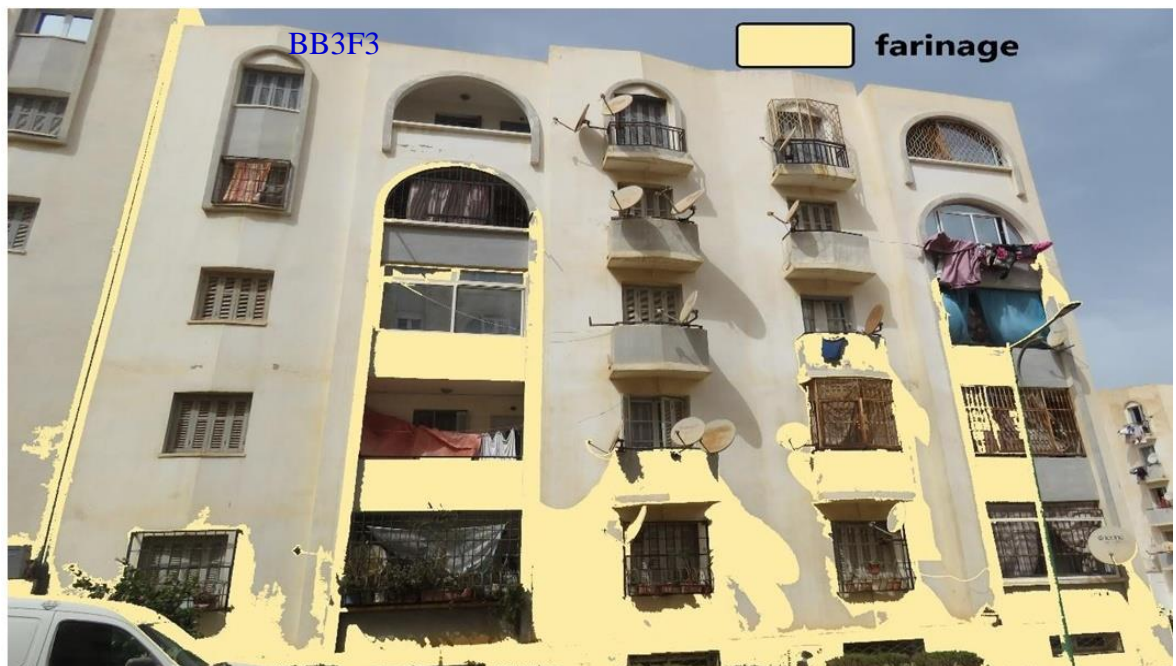
Photo IV.49. Cartographie des altérations des revêtements de peintures –farinage
