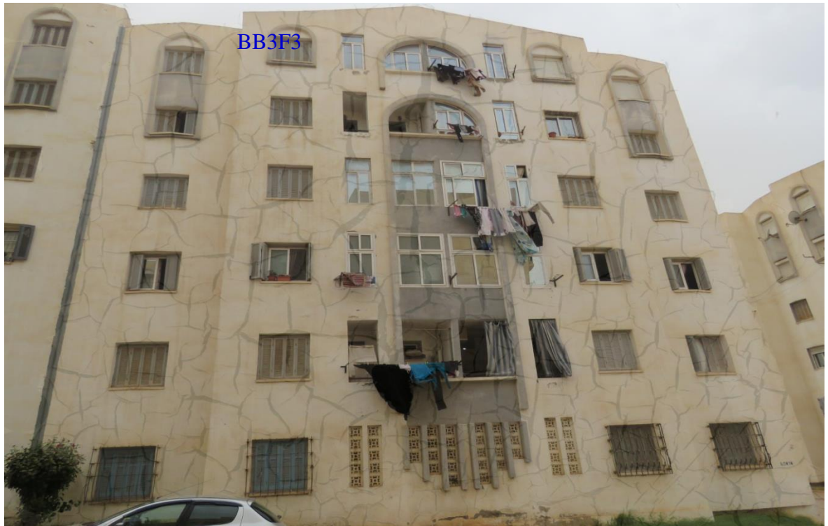
Photo IV.38. Cartographie des altérations des revêtements de peintures –craquellement
