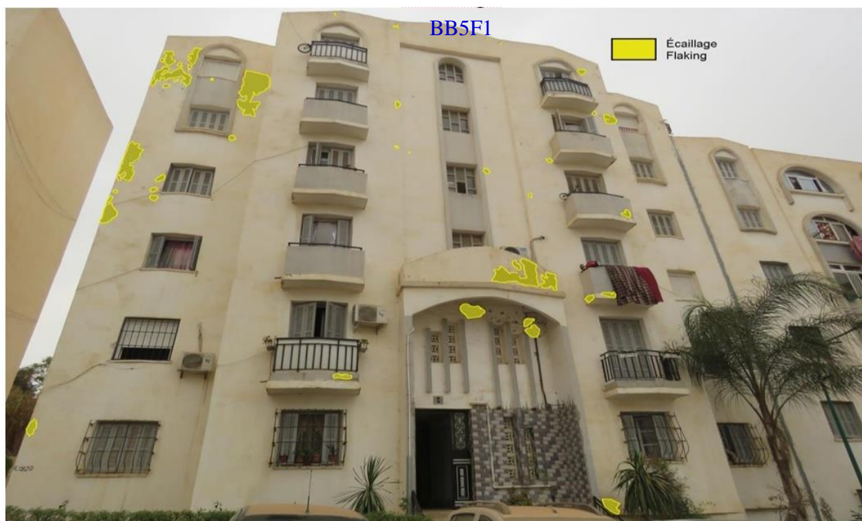
Photo IV.44. Cartographie des altérations des revêtements de peintures –écaillage
