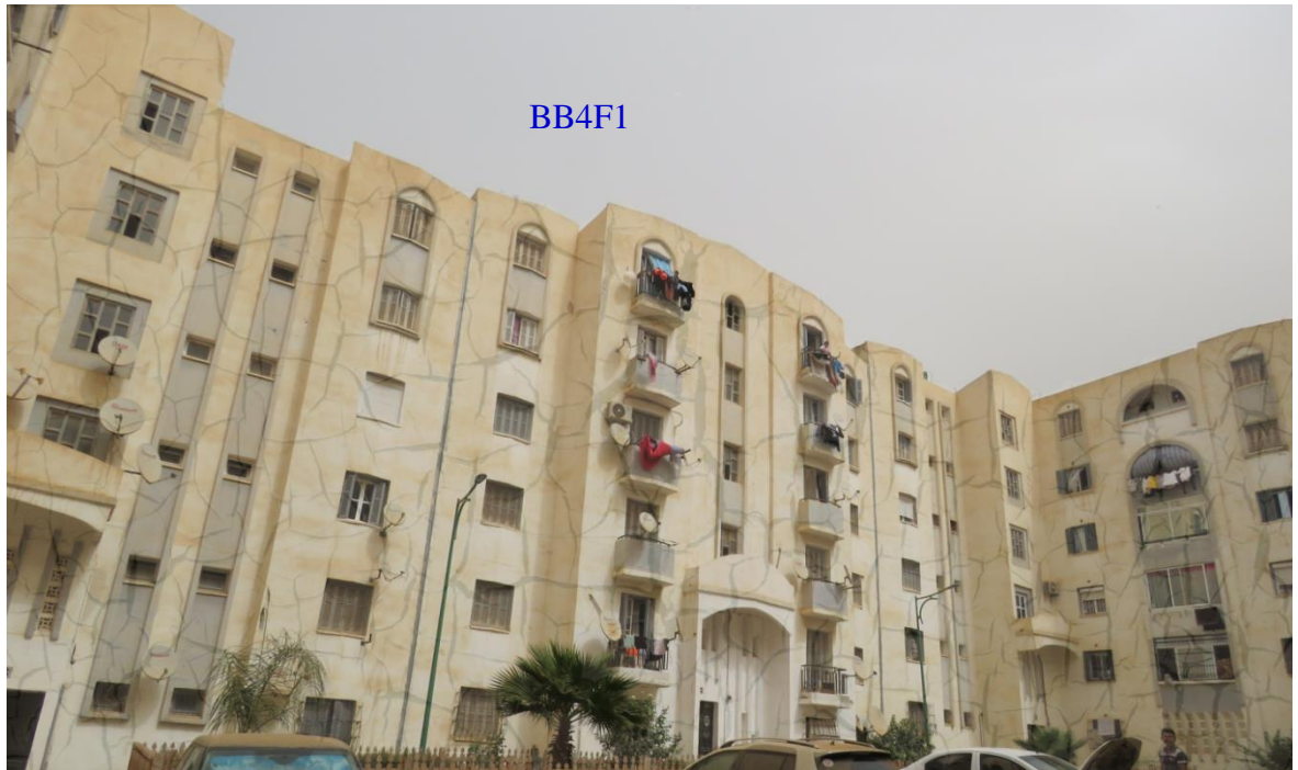
Photo IV.58. Cartographie des altérations des revêtements de peintures –craquellement
