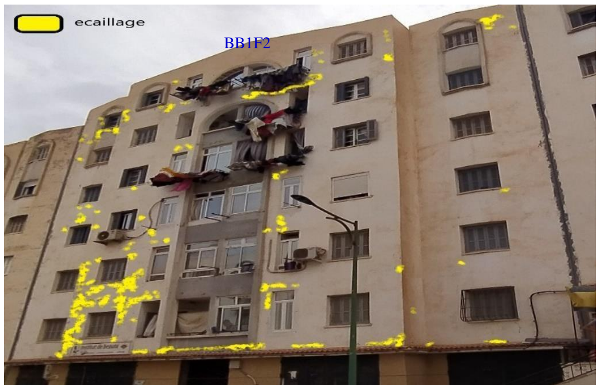
Photo IV.19. Cartographie des altérations des revêtements de peintures – Écaillage
