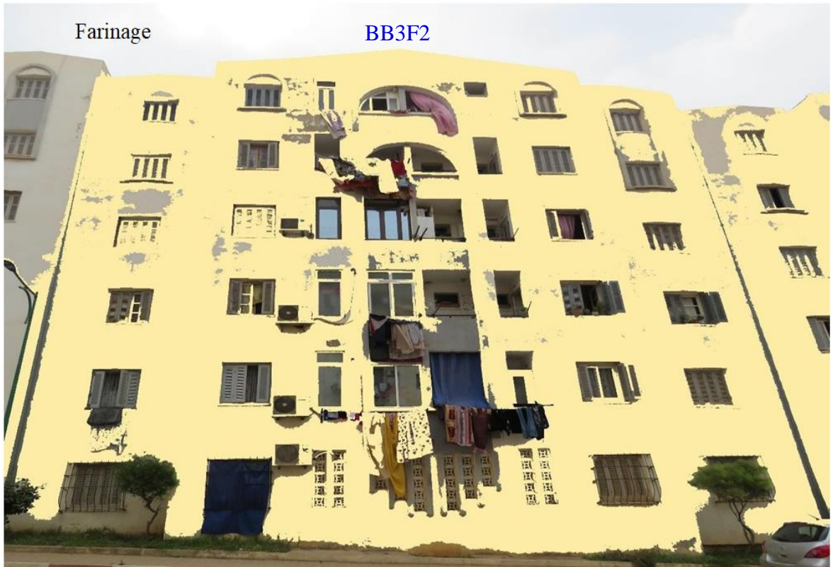
Photo IV.32. Cartographie des altérations des revêtements de peintures –Farinage
