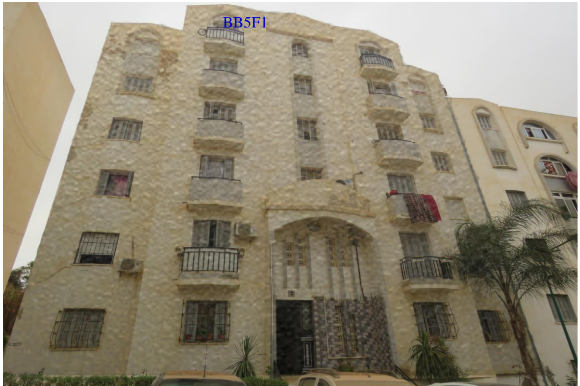
Photo IV.45. Cartographie des altérations des revêtements de peintures –cloquage
