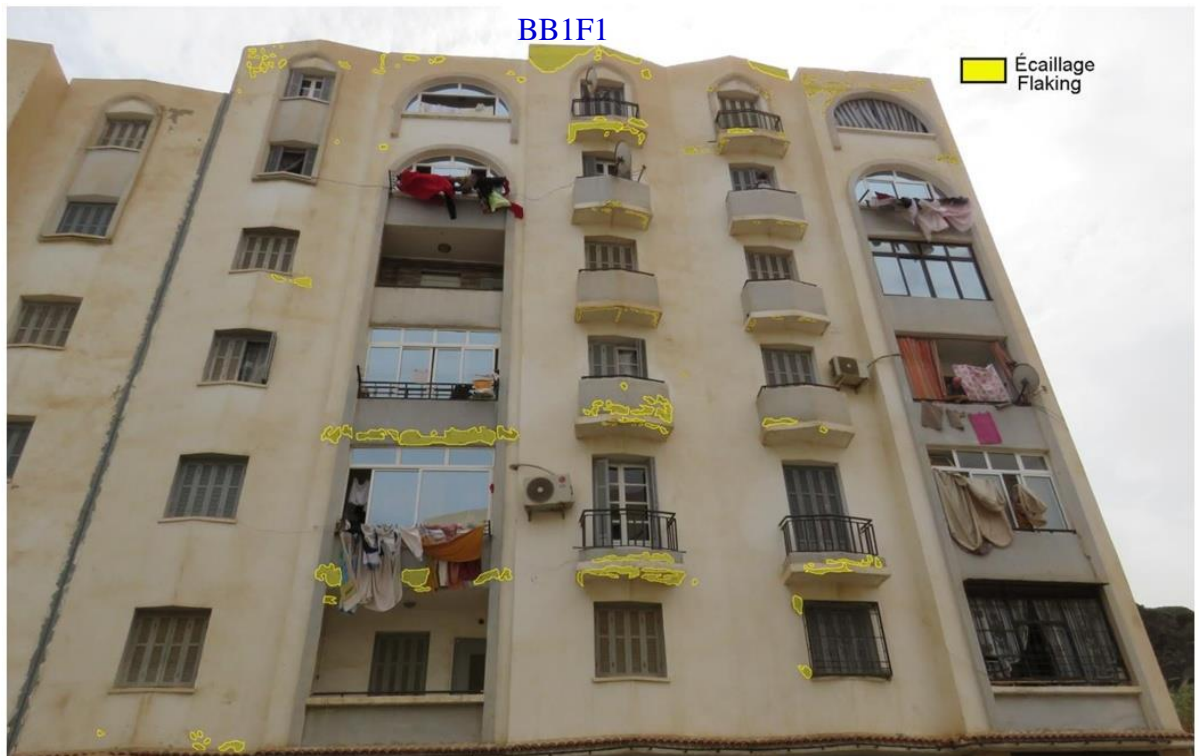
Photo IV.13. Cartographie des altérations des revêtements de peintures –écaillage
