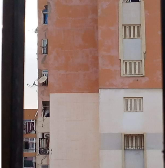
Photo II.11. Efflorescence sur un revêtement de peinture appliqué sur une façade d'un bâtiment (par rabah ben abbes et zekraoui)
