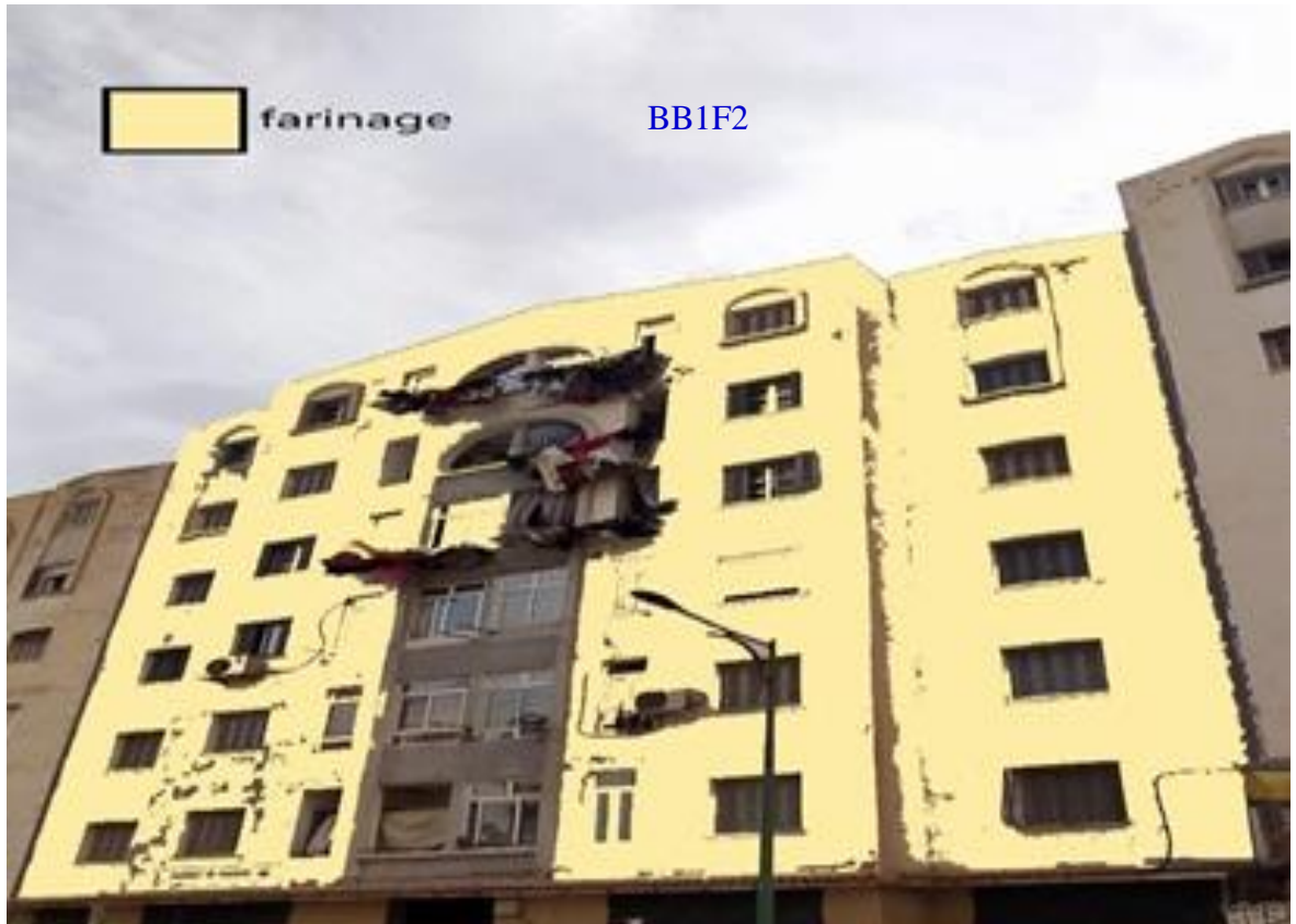
Photo IV.18. Cartographie des altérations des revêtements de peintures –Farinage
