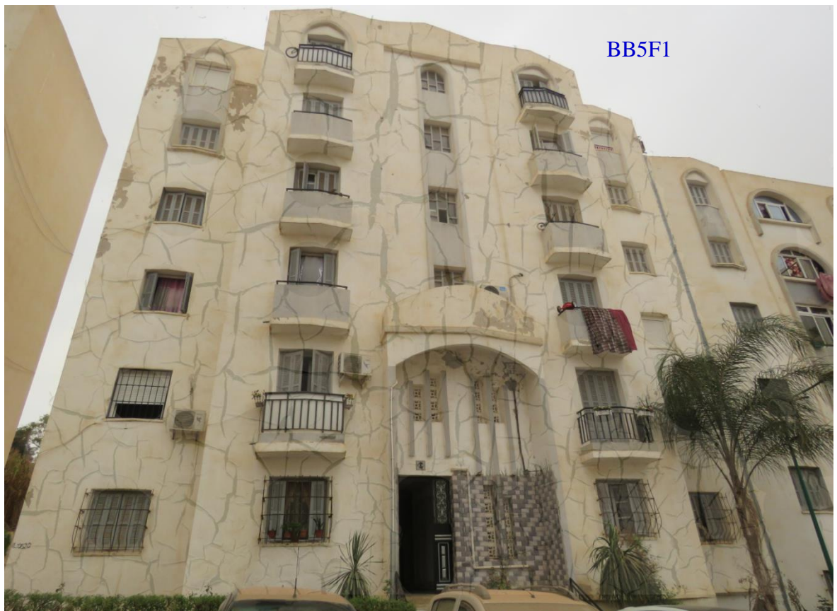
Photo IV.46. Cartographie des altérations des revêtements de peintures –craquellement
