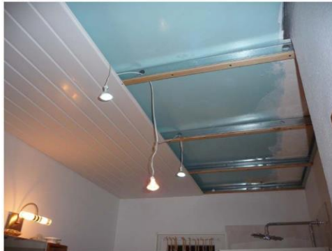
Figure 1.15. Plafond en lambris PVC
