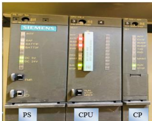
Figure 2.26 -Automate s7-400 associé dans la carrière.
