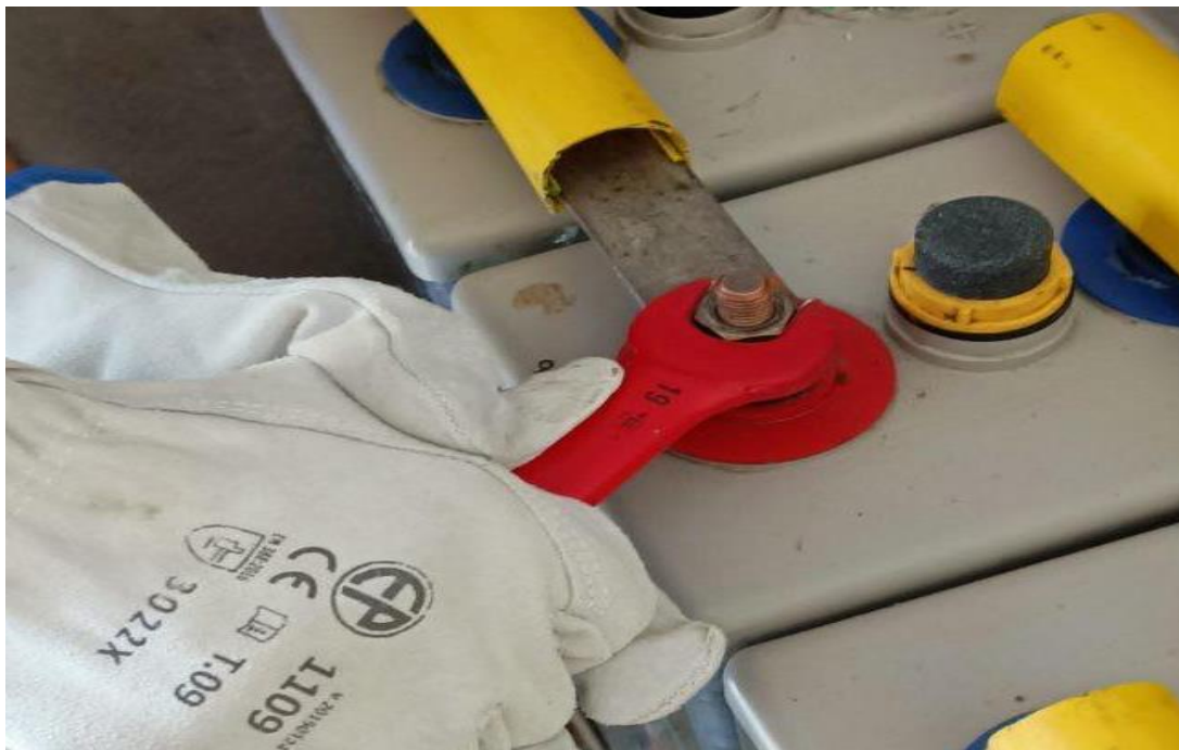
Figure 3- 9 serrage des bornes de batteries
