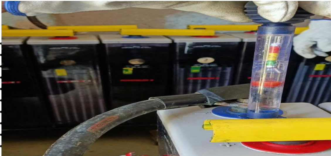
Figure 3- 11 operation de la vérification de l'état de l'électrolyte
