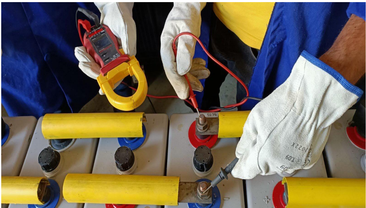
Figure 3- 13 vérification des tensions de batteries
