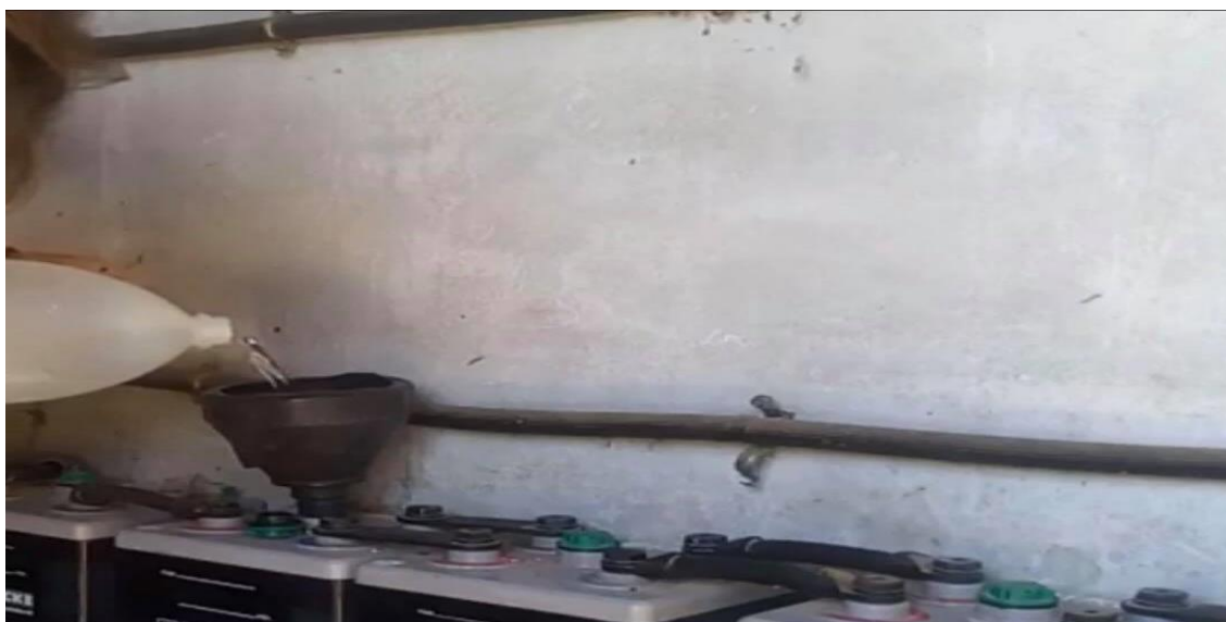
Figure 3- 12 l'ajout de l'eau distillé aux batteries
