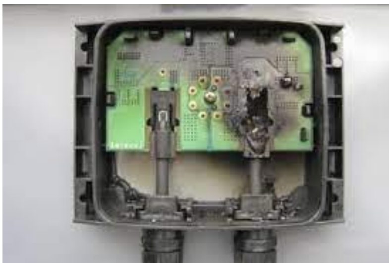
Figure 2- 14 Exemple des défauts rencontré dans la boîte de jonction
