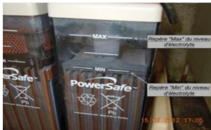
Figure 3- 4 Niveau d'électrolyte dans une batterie
