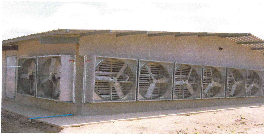
Figure n° 2 : un exemple de ventilation dynamique (Aviagen, 2010).
