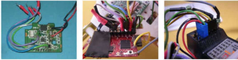
Figure (II.13) : Les câblages
