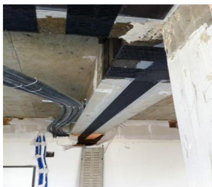
Figure II.9: poutre renforcée par TFC[18].
