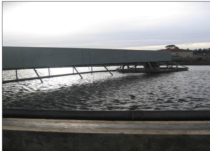
Figure III.2 : les deux clarificateurs de la station
