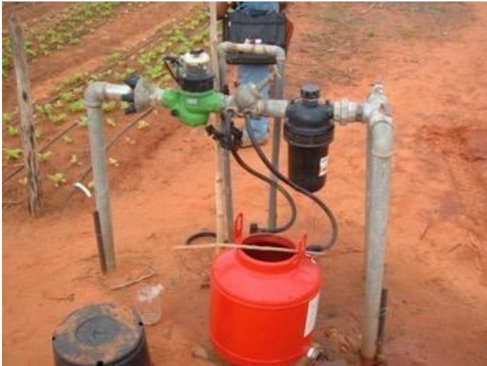
Figure 8 : Eléments de régulation, filtrage et fustigation
