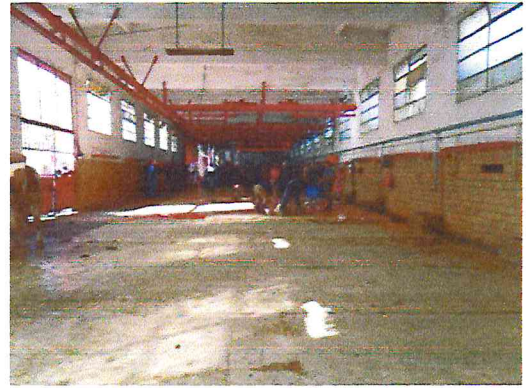
Figure n°8: Etat du plafond.
