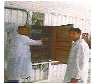
Figure 4 : Armoire de contrôle (Photo personnelle 2011)
