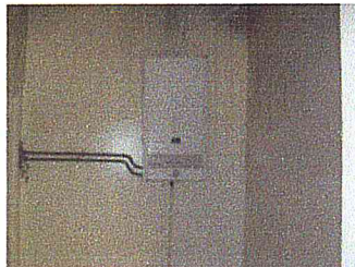
Photos n°17 : chauffe-eau elevage n°01
