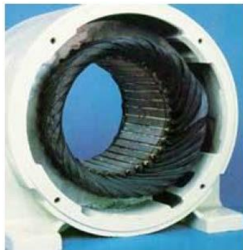
Damage dû à la surcharge
