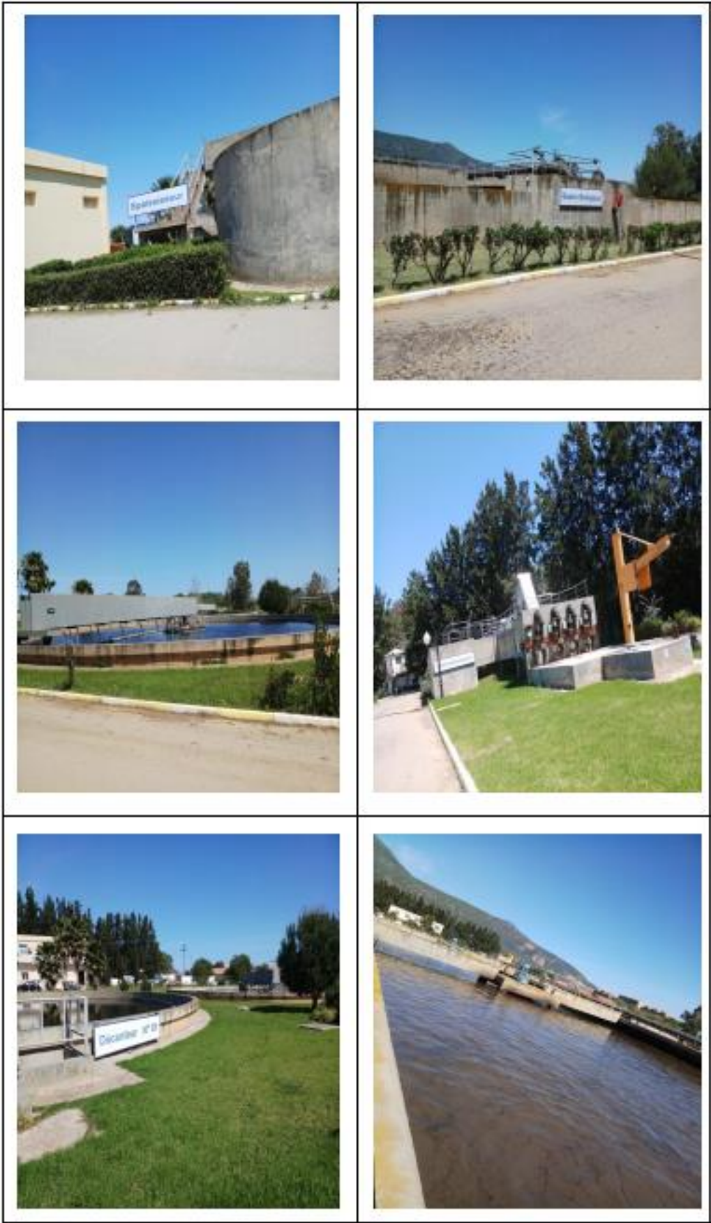
Figure 6. Station d'épuration de Chenoua (photos originales, 2021).
