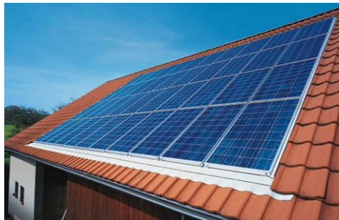
Fig. (VI.21) : panneau photovoltaïque pour compenser les besoins en électricités.
