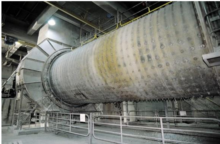
Figure 1.9 : Le broyage de ciment.
