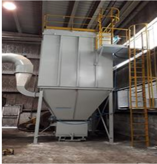
Figure 1.11 : Photo d'un filtre à manche à la cimenterie de Meftah.
