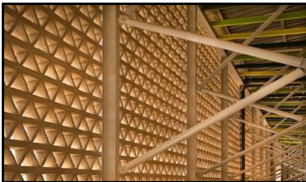
Figure 3.13 : La structure métallique utilisée dans l'université Alioune Diop se trouve dans le lien https://www.akdn.org/fr/architecture consulté le 23-06-2020
