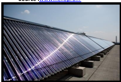
Figure : Panneaux thermiques solaires
