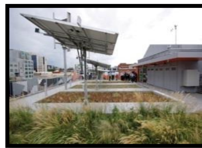
Figure : panneaux photovoltaïques sur terrasse
