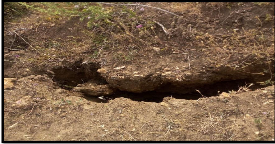
Figure 1- 11: Une photo d'un glissement de terrain du site du projet.
