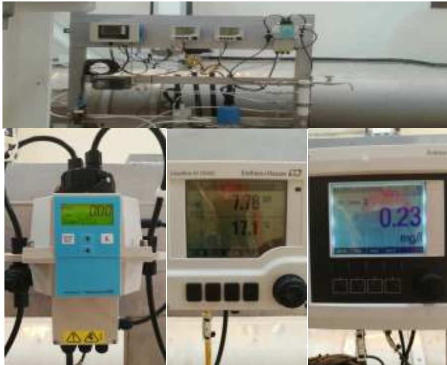
Figure III.16: Contrôle de qualité d'eau produite en ligne (mai 2018)
