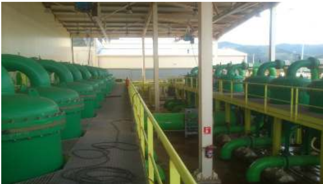
Figure III.10: Les filtres à cartouches (mai 2018)
