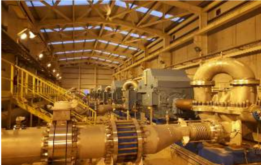
Figure III.17: Pompage d'eau produite (mai 2018)
