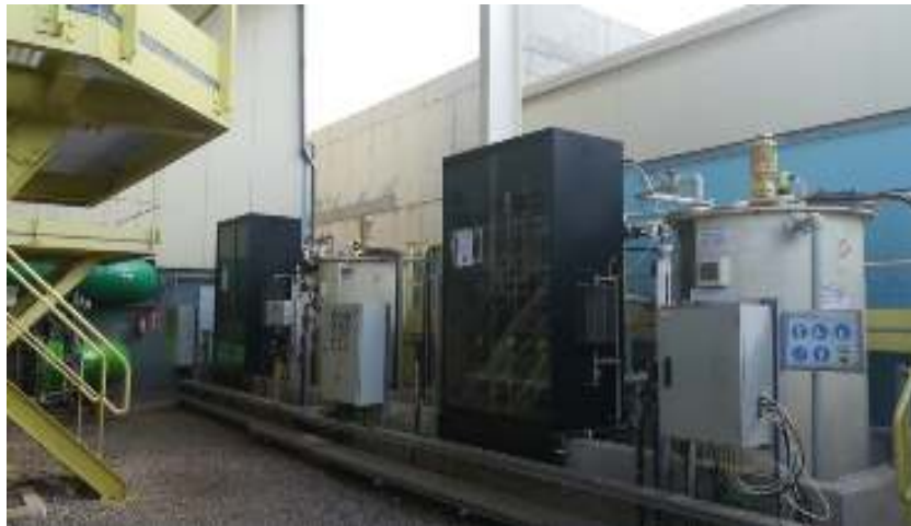
Figure III.8: Poste d'injection des produits chimique (mai 2018)
