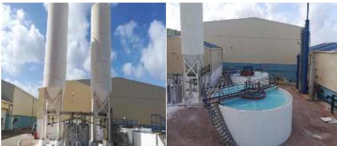
Figure III.15: Point d'injection de chaux et de \text{CO}_2 (mai 2018)
