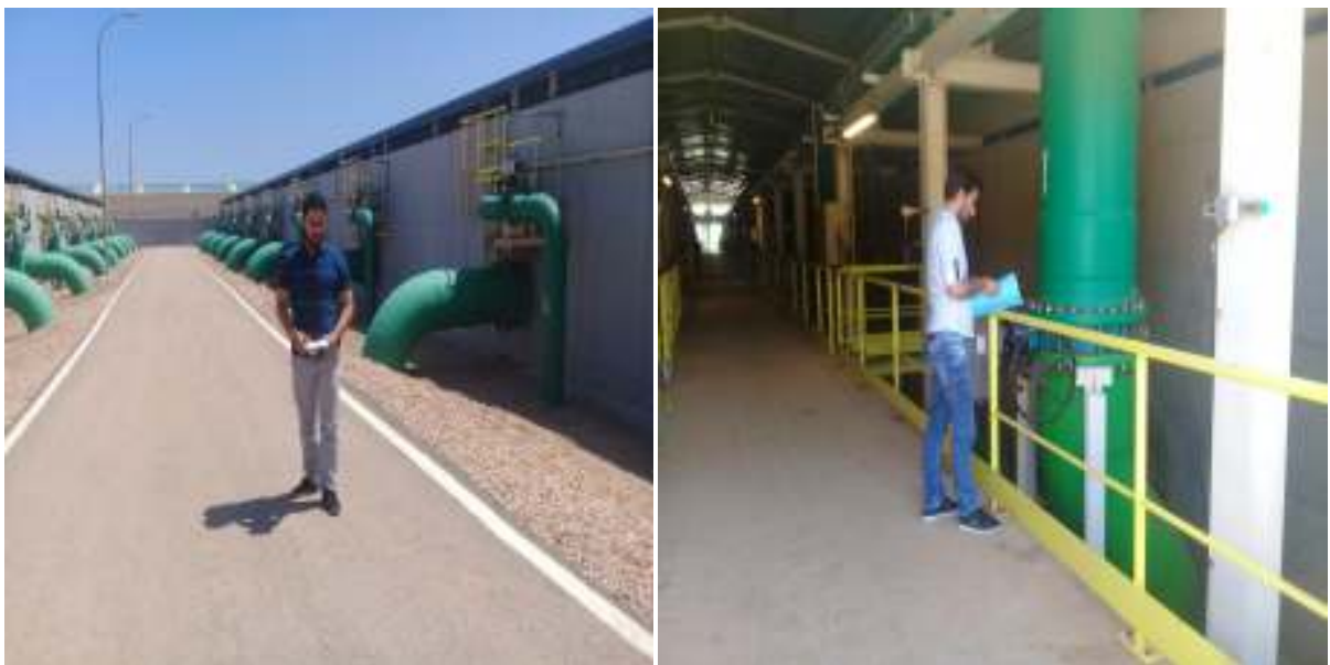
Figure III.6: Les filtres à sable de la station de dessalement de Ténès (juin 2018)
