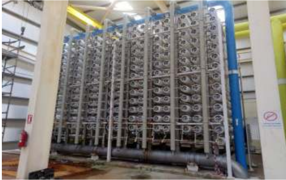
Figure III.12: Un rack dans le bâtiment d'osmose inverse (mai 2018)
