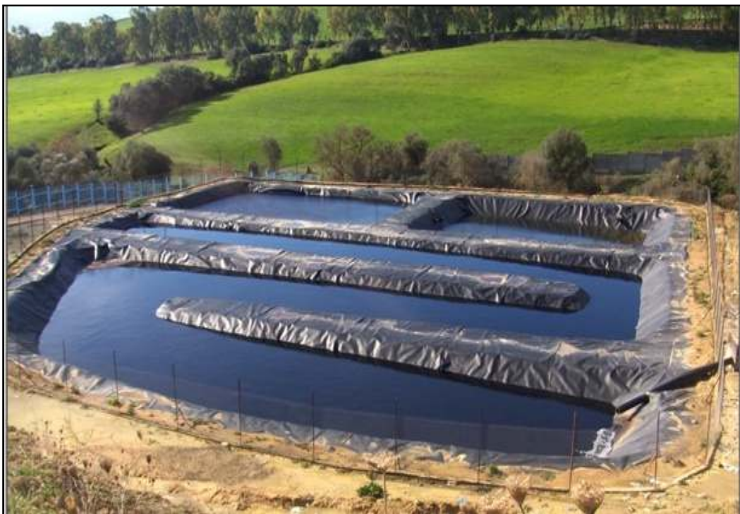
Photo17 : Bassin de récupération de lixiviat
