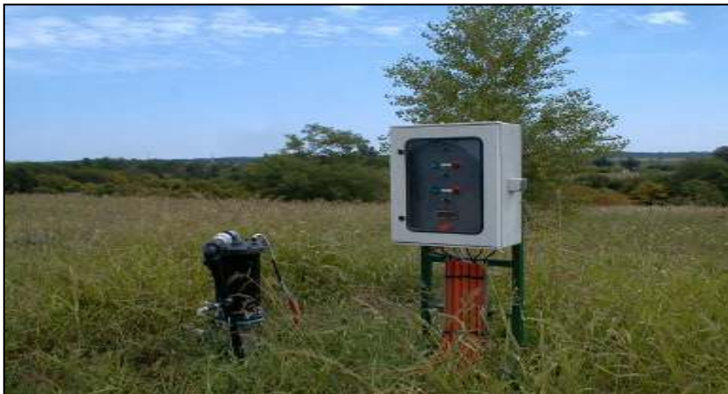
Figure .III.01 : le puits de dégazage [12]
