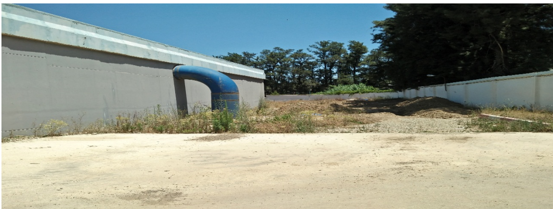
Figure V.2 : Conduite de départ
