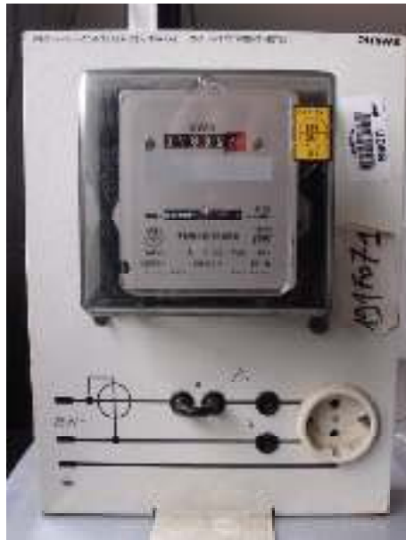
Figure III.3 : Compteur d'énergie électrique à courant alternatif AC.
