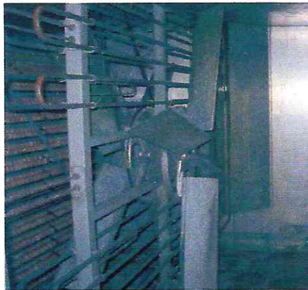
Photo n° 6 : Le système de refroidissement et de ventilation
